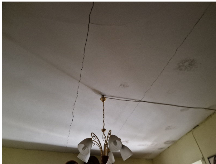
FO_ 12 Controsoffitto vano di ingresso UNITA' DUE
