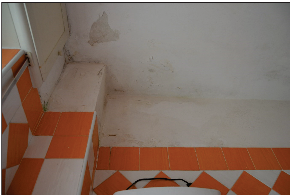
Foto 5 (tracce di fenomeni infiltrativi alle pareti ed al soffitto del locale W.C. al piano terra)
