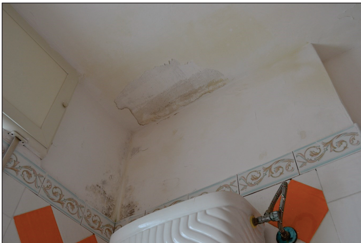
Foto 3 (tracce di fenomeni infiltrativi al soffitto ed alle pareti del locale W.C. al primo piano)
