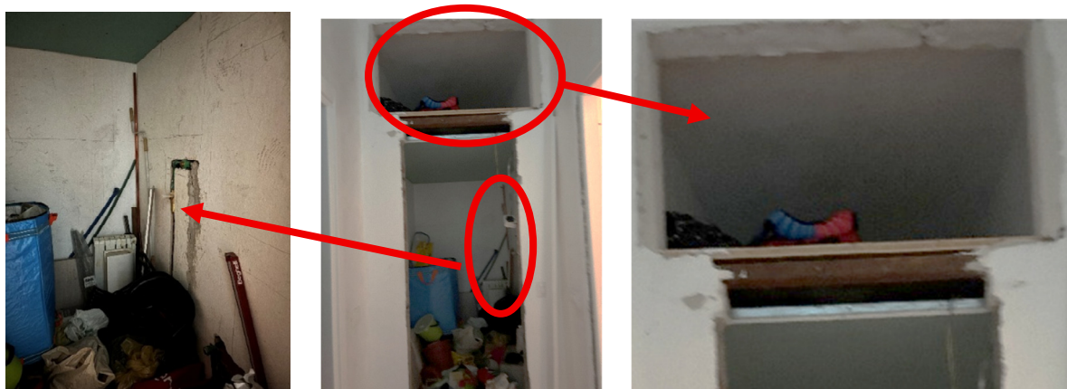
Impianti nel ripostiglio – controsoffitto portante via G. Di Vittorio 67 San Donato Milanese
