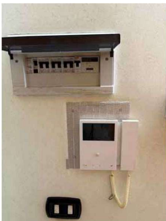
Foto 15: Particolare quadro elettrico generale e videocitofono
