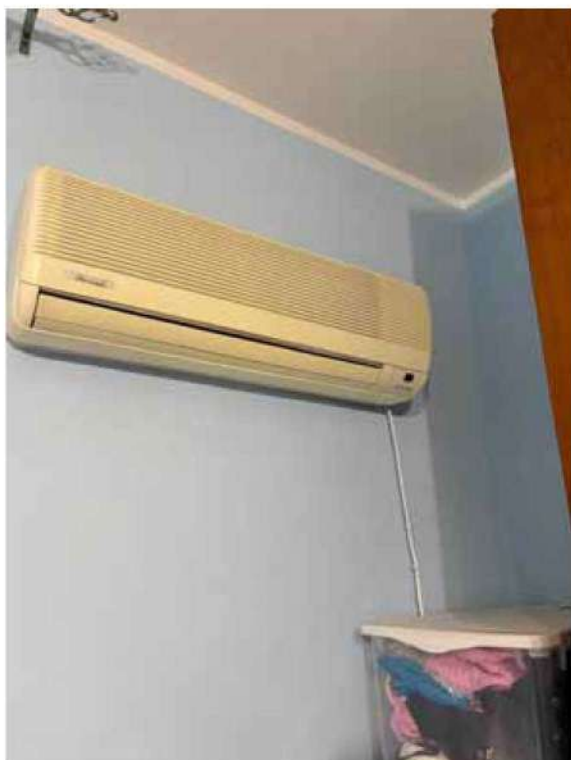
Foto 13: Condizionatore autonomo camera
