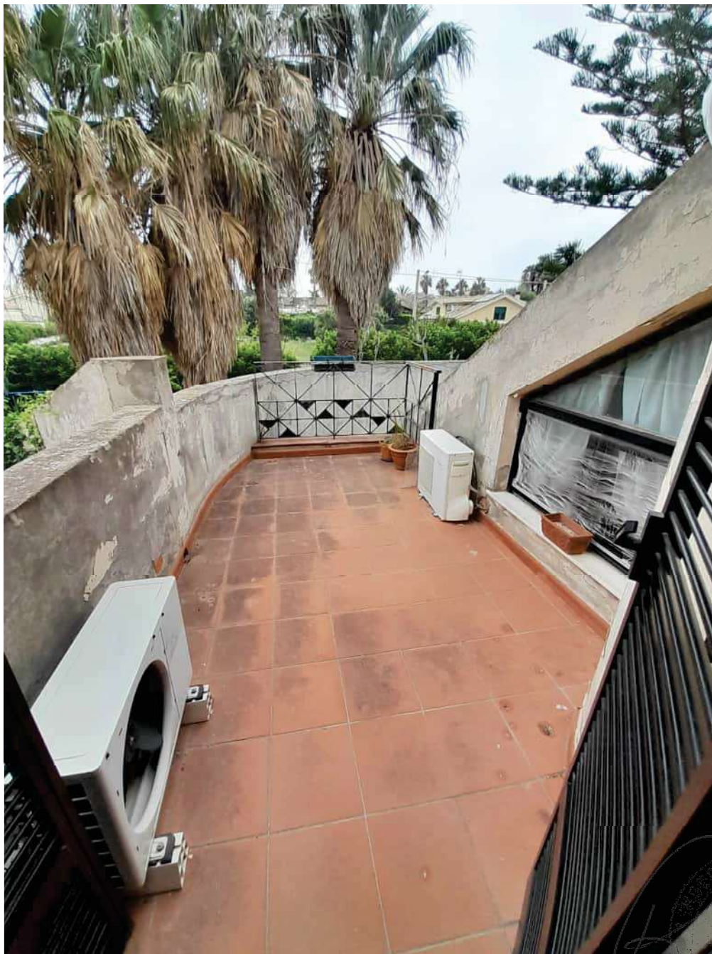
Foto n°25 - Vista del terrazzino ampliato abusivamente di pertinenza alla camera da letto singola
