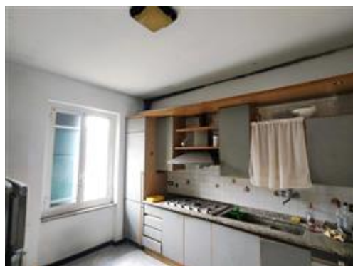
cucina - problematiche sui ponti termici
