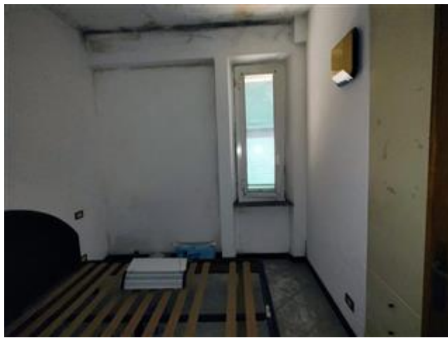
cameretta - problematiche sui ponti termici
