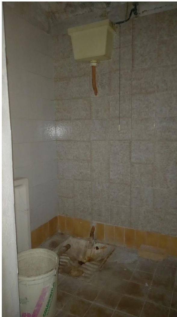
Foto 7: Servizio igienico in pessimo stato di conservazione e manutenzione
