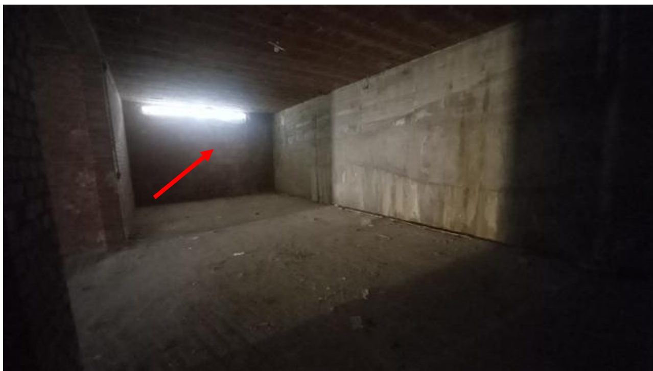
Foto 9: Magazzino con apertura chiusa (difformità)
