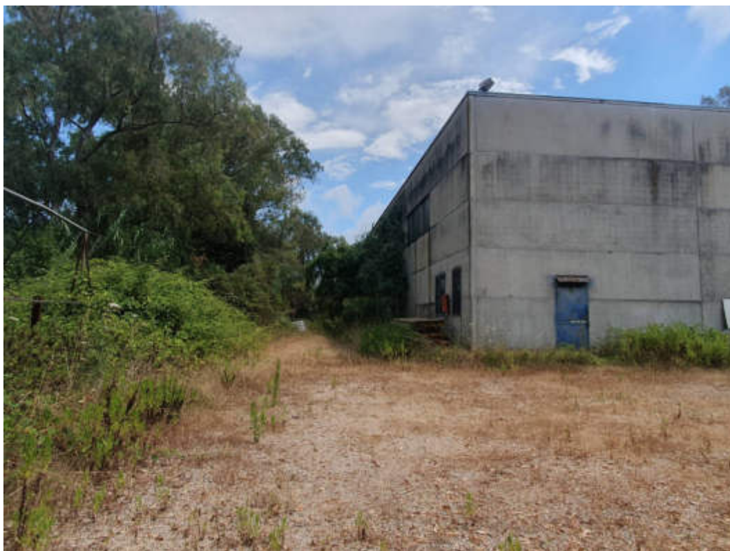
FOTO N. 19: COMPLESSO INDUSTRIALE SITO IN SESSA AURUNCA ALLA STRADA PROVINCIALE N.132 CENSITO IN N.C.F. AL FOGLIO 189 P.LLA 92 SUB 1 AREA ESTERNA AL CAPANNONE 1 INFESTATA DA CESPUGLI DI ROVI E STERPAGLIE – VISUALE EST
