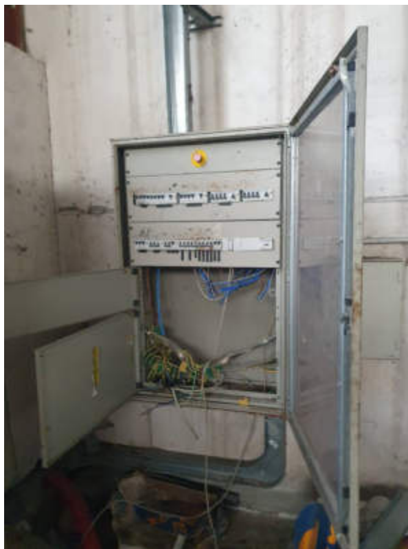
FOTO N. 13: COMPLESSO INDUSTRIALE SITO IN SESSA AURUNCA ALLA STRADA PROVINCIALE N.132 CENSITO IN N.C.F. AL FOGLIO 189 P.LLA 92 SUB 1 CAPANNONE 1 – QUADRO ELETTRICO DEPREDATO
