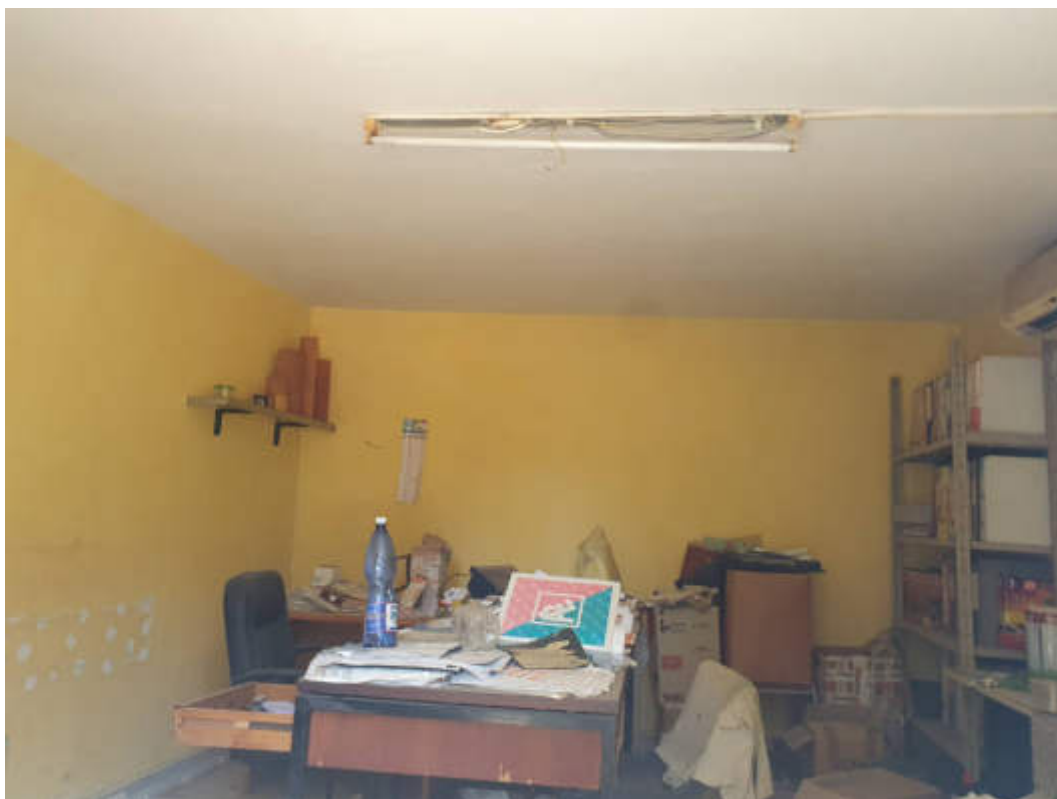
FOTO N. 4: COMPLESSO INDUSTRIALE SITO IN SESSA AURUNCA ALLA STRADA PROVINCIALE N.132 CENSITO IN N.C.F. AL FOGLIO 189 P.LLA 92 SUB 1 FABBRICATO UFFICI – INTERNI IN TOTALE STATO DI ABBANDONO E DI DEGRADO
