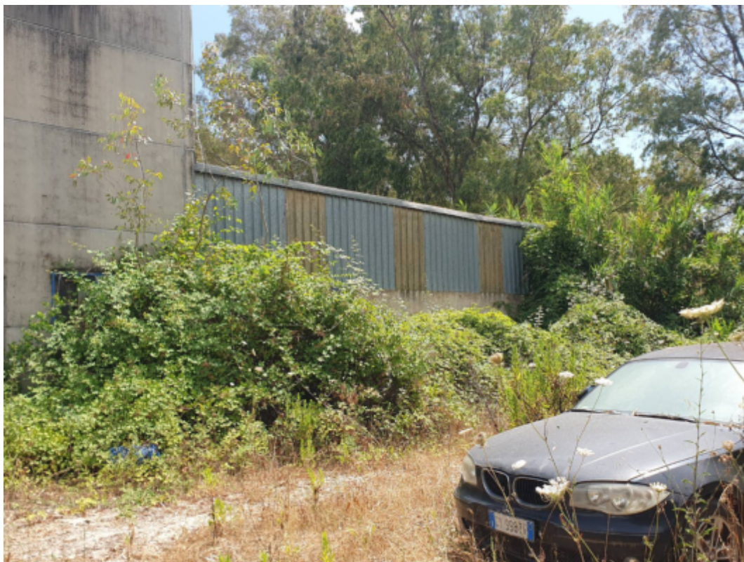
FOTO N. 16: COMPLESSO INDUSTRIALE SITO IN SESSA AURUNCA ALLA STRADA PROVINCIALE N.132 CENSITO IN N.C.F. AL FOGLIO 189 P.LLA 92 SUB 1 AMPLIAMENTO AL CAPANNONE 1 – AREA ESTERNA DEGRADATA CON ROVI E STERPAGLIE VISUALE NORD-EST
