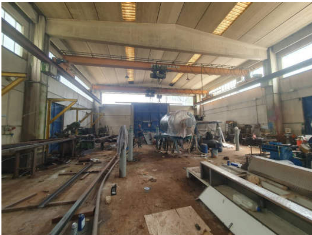
FOTO N. 10: COMPLESSO INDUSTRIALE SITO IN SESSA AURUNCA ALLA STRADA PROVINCIALE N.132 CENSITO IN N.C.F. AL FOGLIO 189 P.LLA 92 SUB 1 CAPANNONE 1 – INTERNI IN TOTALE STATO DI ABBANDONO E DI DEGRADO
