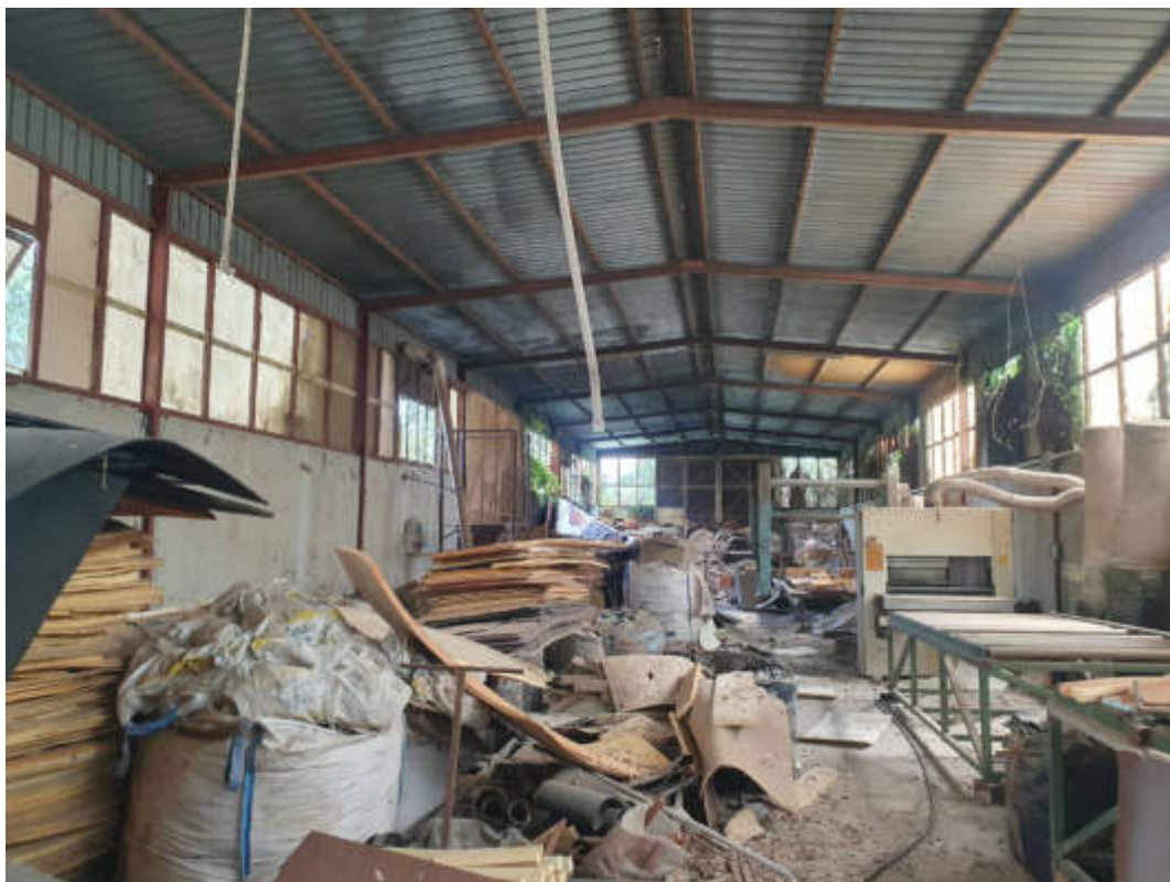
FOTO N. 26: COMPLESSO INDUSTRIALE SITO IN SESSA AURUNCA ALLA STRADA PROVINCIALE N.132 CENSITO IN N.C.F. AL FOGLIO 189 P.LLA 92 SUB 1 CAPANNONE 2 – INTERNI IN TOTALE STATO DI ABBANDONO E DI DEGRADO
