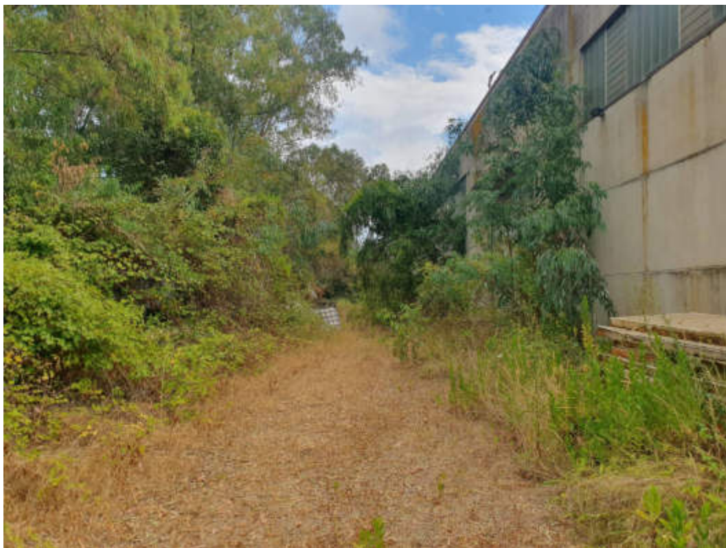
FOTO N. 20: COMPLESSO INDUSTRIALE SITO IN SESSA AURUNCA ALLA STRADA PROVINCIALE N.132 CENSITO IN N.C.F. AL FOGLIO 189 P.LLA 92 SUB 1 AREA ESTERNA AL CAPANNONE 1 INFESTATA DA CESPUGLI DI ROVI E STERPAGLIE – VISUALE EST
