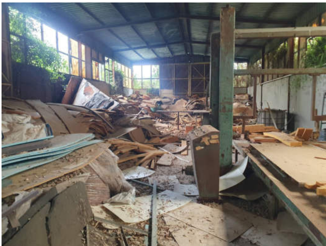
FOTO N. 27: COMPLESSO INDUSTRIALE SITO IN SESSA AURUNCA ALLA STRADA PROVINCIALE N.132 CENSITO IN N.C.F. AL FOGLIO 189 P.LLA 92 SUB 1 CAPANNONE 2 – INTERNI IN TOTALE STATO DI ABBANDONO E DI DEGRADO
