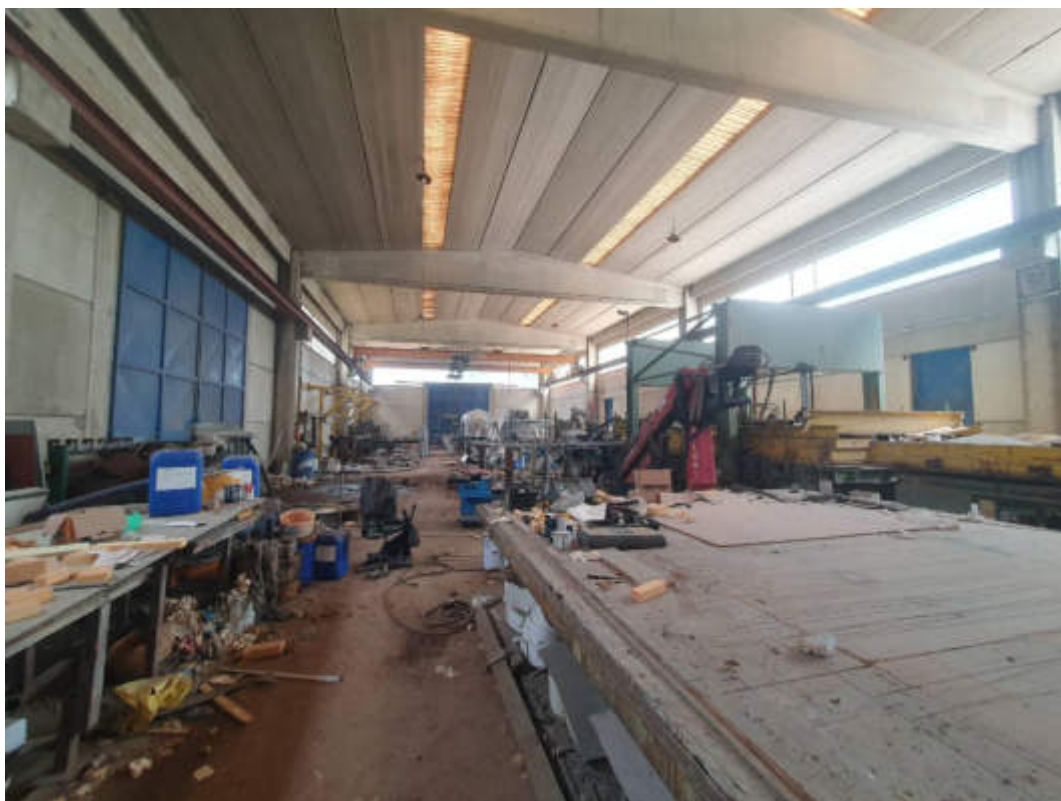
FOTO N. 8: COMPLESSO INDUSTRIALE SITO IN SESSA AURUNCA ALLA STRADA PROVINCIALE N.132 CENSITO IN N.C.F. AL FOGLIO 189 P.LLA 92 SUB 1 CAPANNONE 1 – INTERNI IN TOTALE STATO DI ABBANDONO E DI DEGRADO
