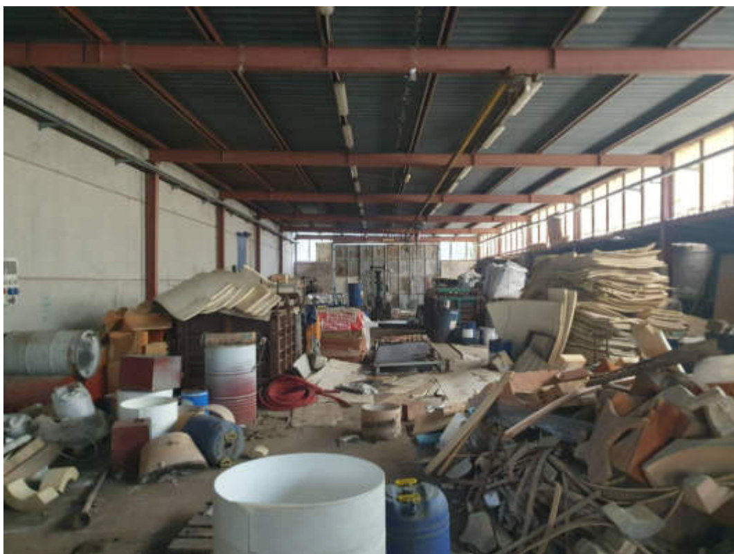
FOTO N. 17: COMPLESSO INDUSTRIALE SITO IN SESSA AURUNCA ALLA STRADA PROVINCIALE N.132 CENSITO IN N.C.F. AL FOGLIO 189 P.LLA 92 SUB 1 AMPLIAMENTO AL CAPANNONE 1 – INTERNI IN TOTALE STATO DI ABBANDONO E DI DEGRADO
