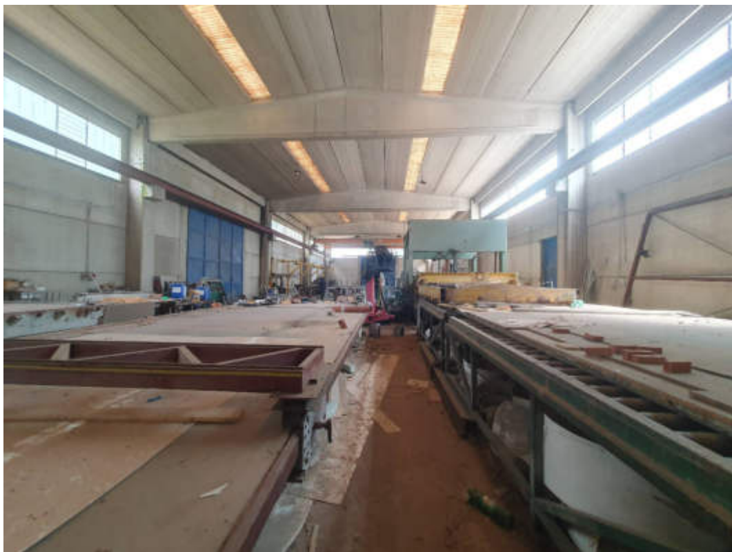
FOTO N. 9: COMPLESSO INDUSTRIALE SITO IN SESSA AURUNCA ALLA STRADA PROVINCIALE N.132 CENSITO IN N.C.F. AL FOGLIO 189 P.LLA 92 SUB 1 CAPANNONE 1 – INTERNI IN TOTALE STATO DI ABBANDONO E DI DEGRADO
