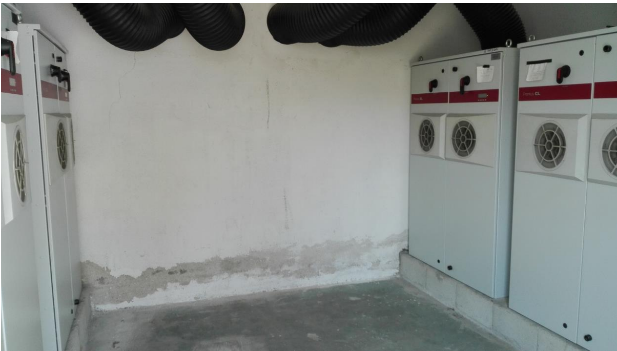
Foto 85. Locale deposito, utilizzato per l'impianto fotovoltaico.
