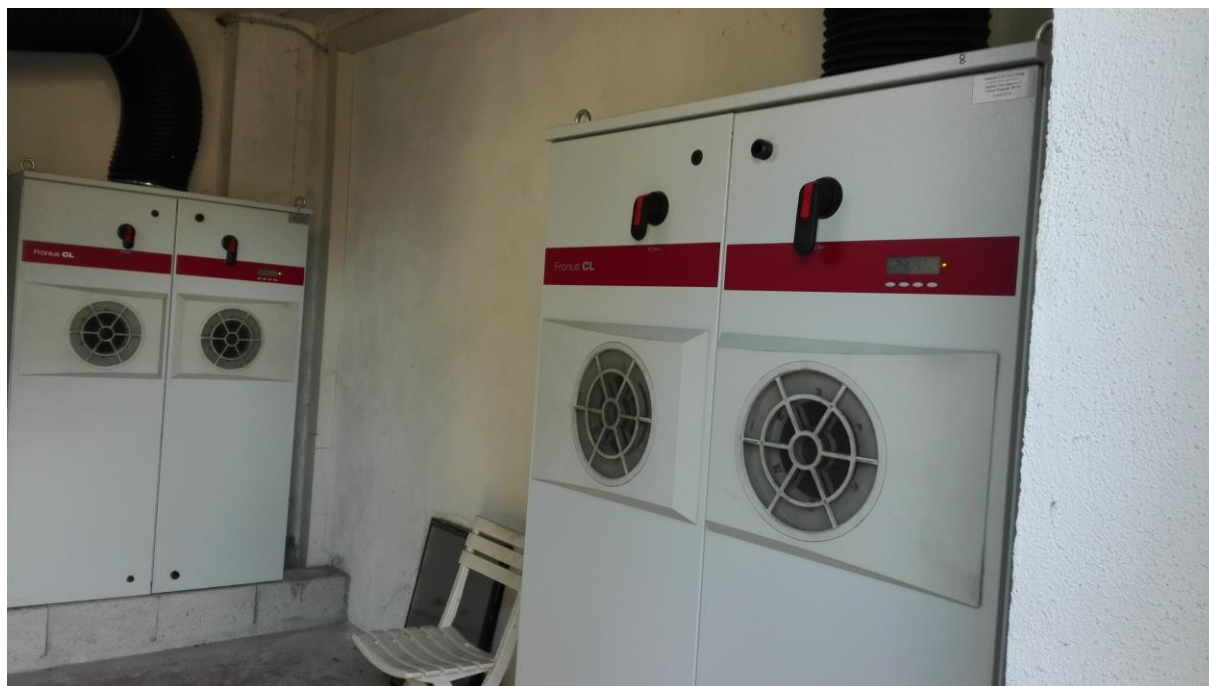
Foto 71-72-73. Locale deposito inverter dell'impianto tecnologico fotovoltaico.
