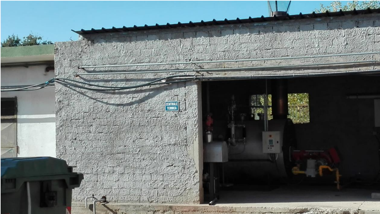
Foto 88. Costruzione non accatastata adiacente al corpo B.
