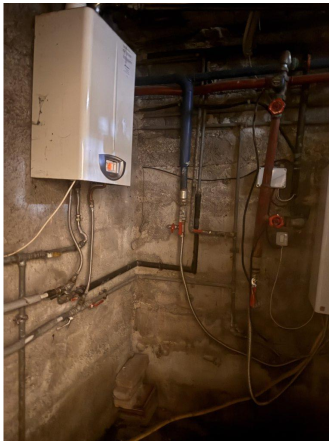
20. Vista della centrale termica
