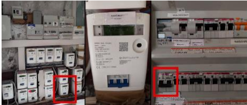
Figura 18- Alloggiamento contatori autorimessa piano terra
