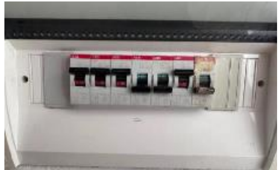
Figura 12- Quadro elettrico nell'appartamento
