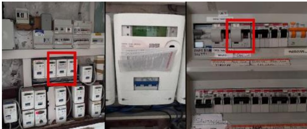
Figura 13- Alloggiamento contatori appartamento piano terra
