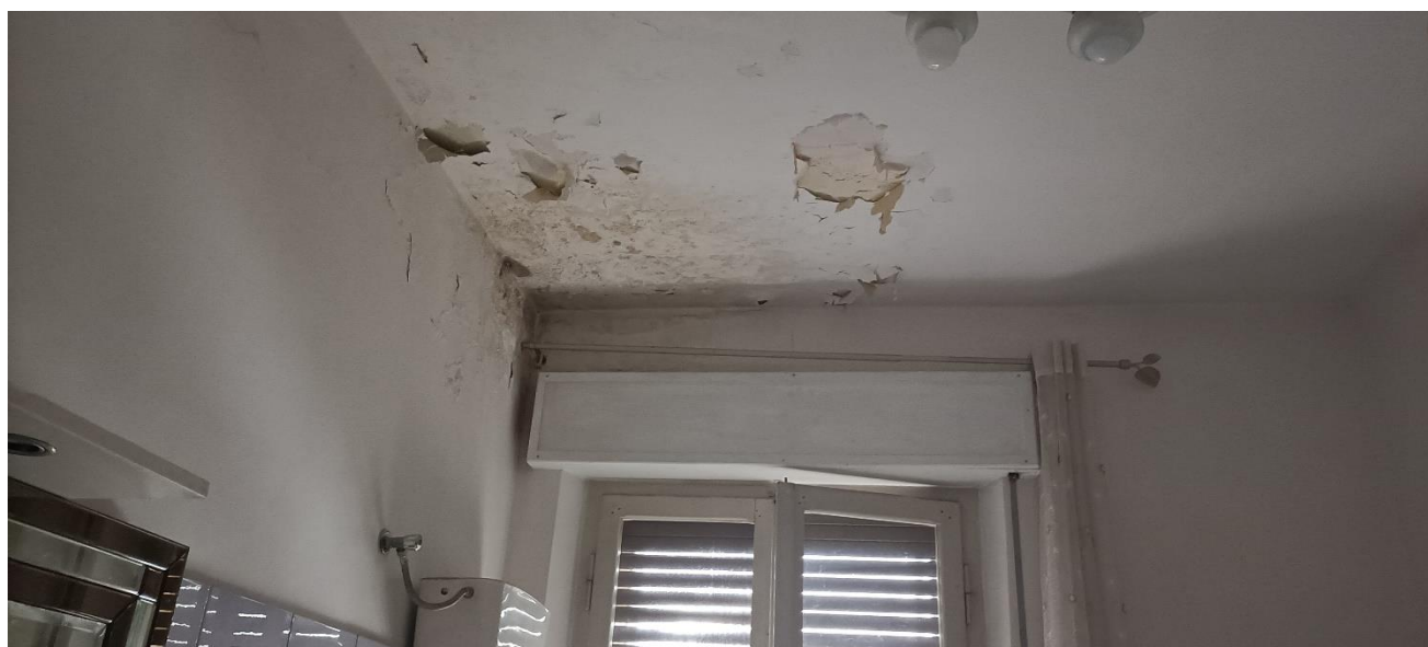
Foto n.10: Altro particolare del bagno dove sono presenti macchie di umidità nel muro in corrispondenza degli spigoli.
