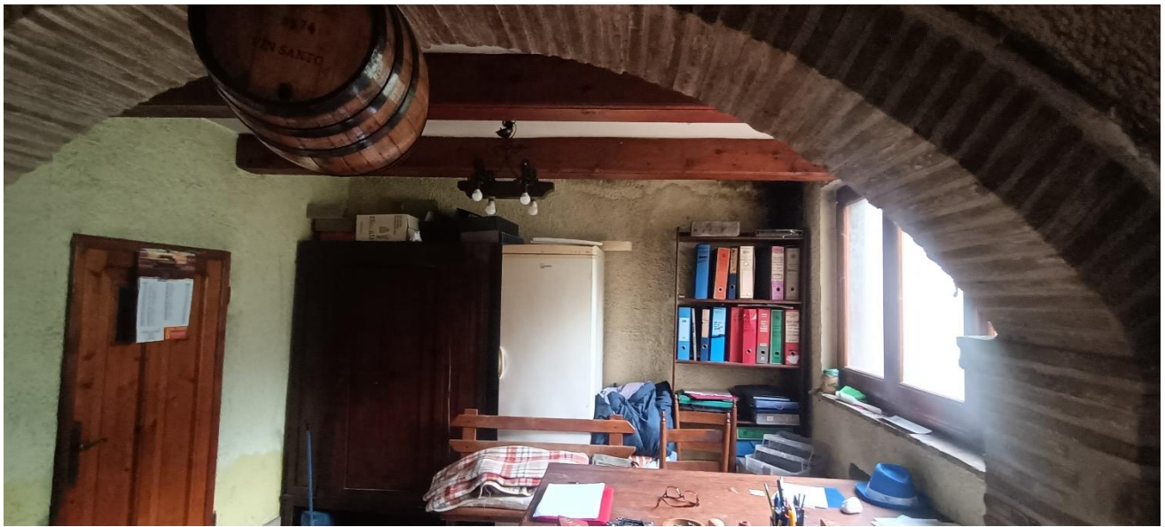
Foto n.15: Particolare dell'altro vano sempre adibito a taverna che costituisce ampliamento realizzato in difformità dal titolo autorizzato.
