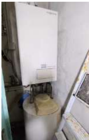
Caldaia centr. termica
