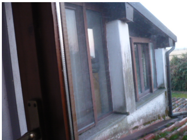
23 – Vista ampliamento abusivo
