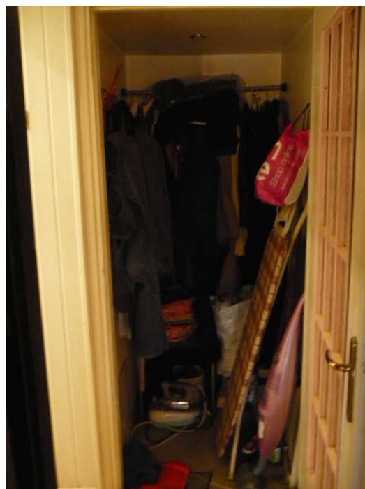
12 – Ripostiglio (non autorizzato)
