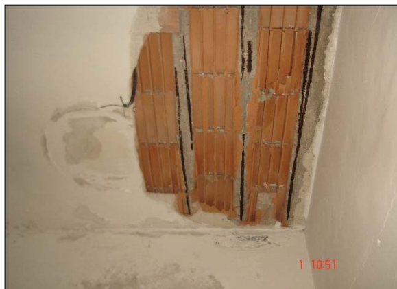
Foto n. 12 – Vista soffitto danneggiato w.c.-bagno
