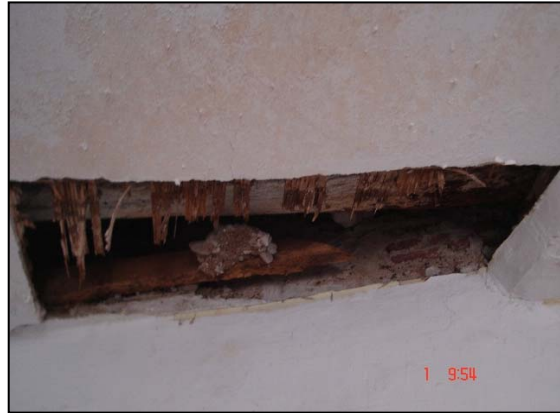
Foto n. 8 – Vista soffitto danneggiato
