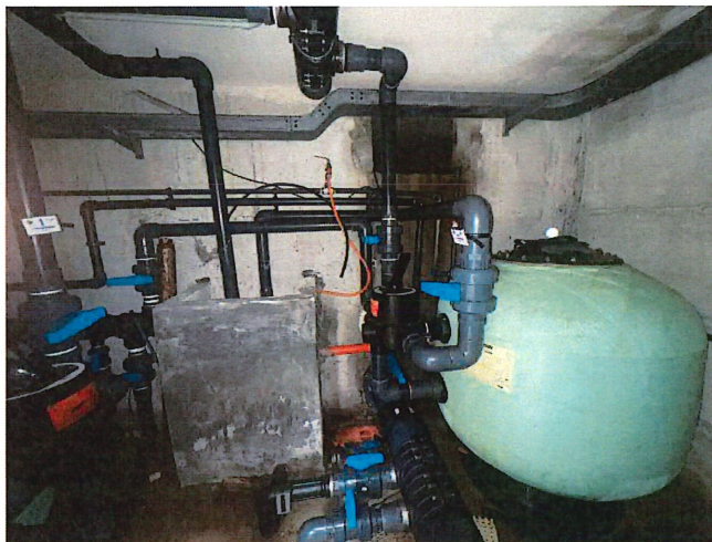
FOTO LOCALE TECNICO PISCINA
