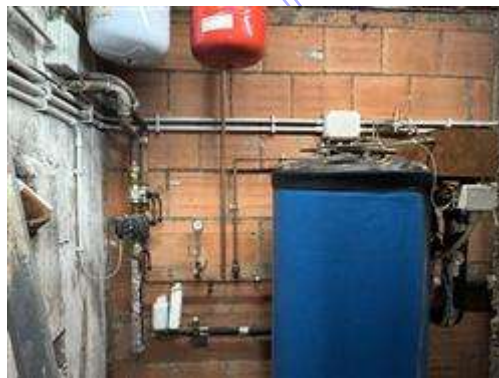
Caldaia non funzionante
