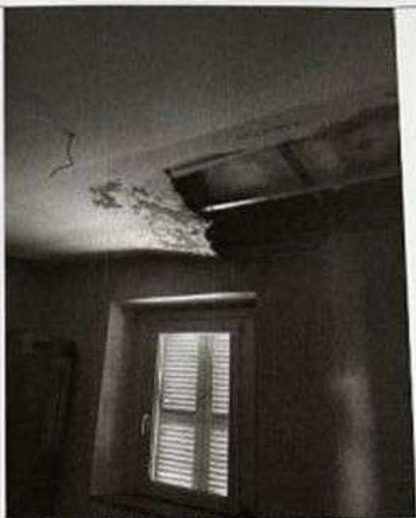
Immagine 14 - Controsoffittatura ammalorata della camera 1
