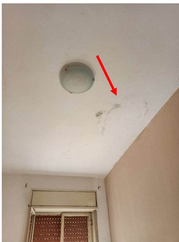
Foto n.14 – ammaloramenti soffitto ripostiglio
