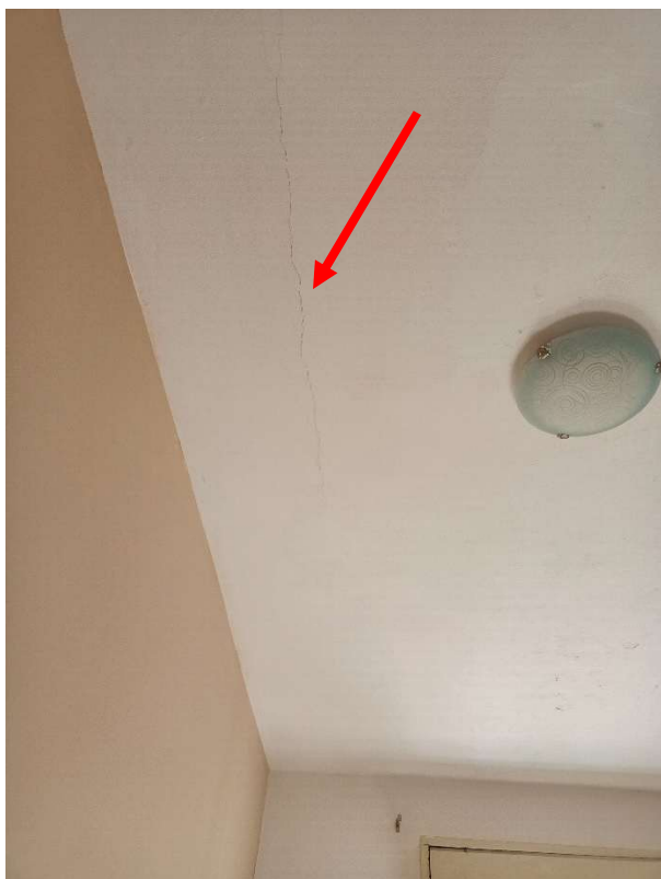
Foto n.13 – lieve lesione soffitto ripostiglio
