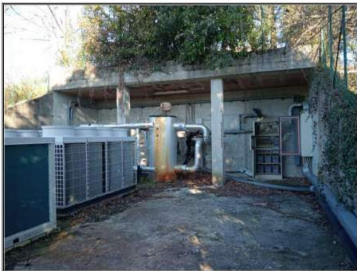
FOTO N° 12 (IMPIANTI A SERVIZIO ALBERGO)
