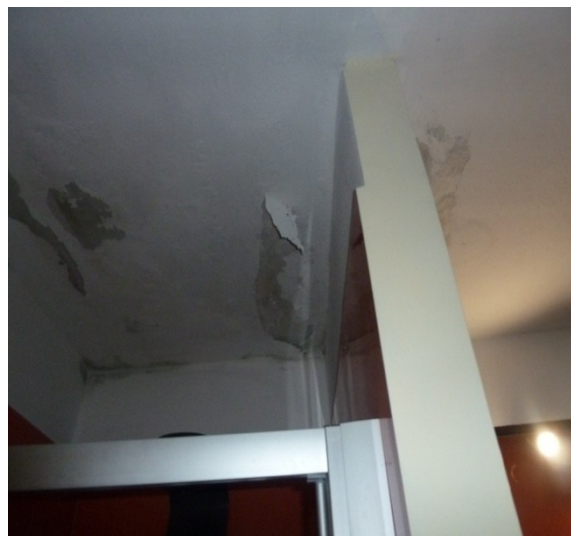
Foto n. 21 segni di infiltrazioni esterne
