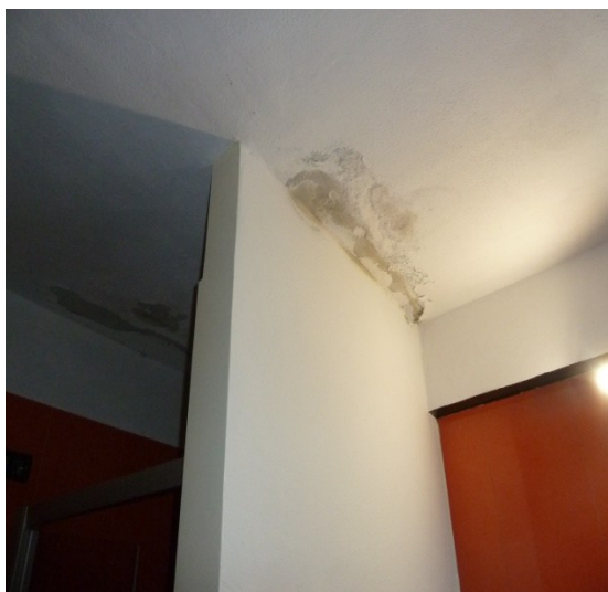
Foto n. 20 segni di umidità
