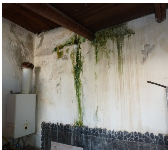
Foto n. 27 segni di infiltrazioni esterne
