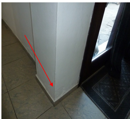
Foto n. 26 segni di umidità
