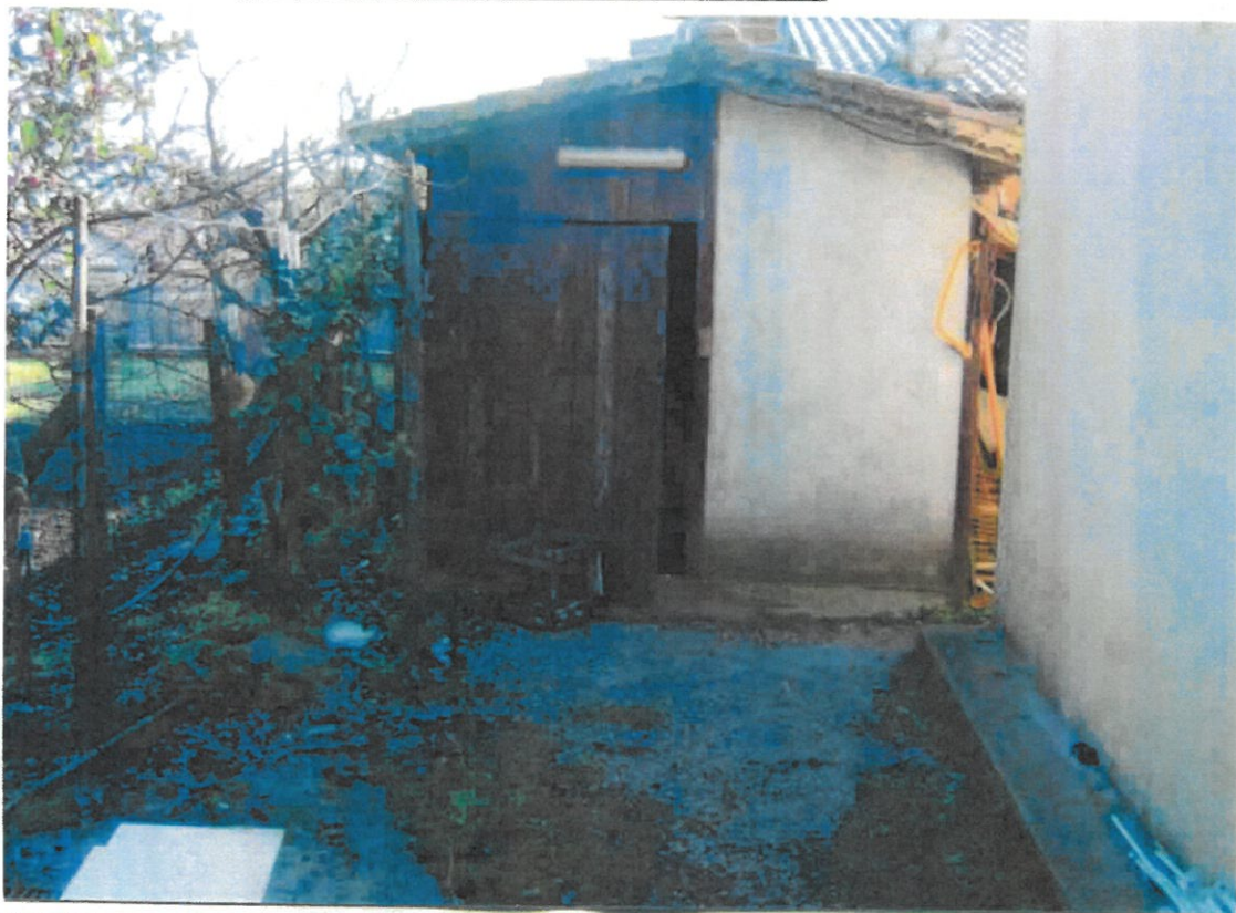
Foto n. 35 – Manufatto in muratura da ridurre in pristino, ubicato sulla corte comune in prossimità dell'abitazione (piano terra – LOTTO N. 3) sita in Lariano (Rm) – Piazzale Martiri della Libertà n. 3
