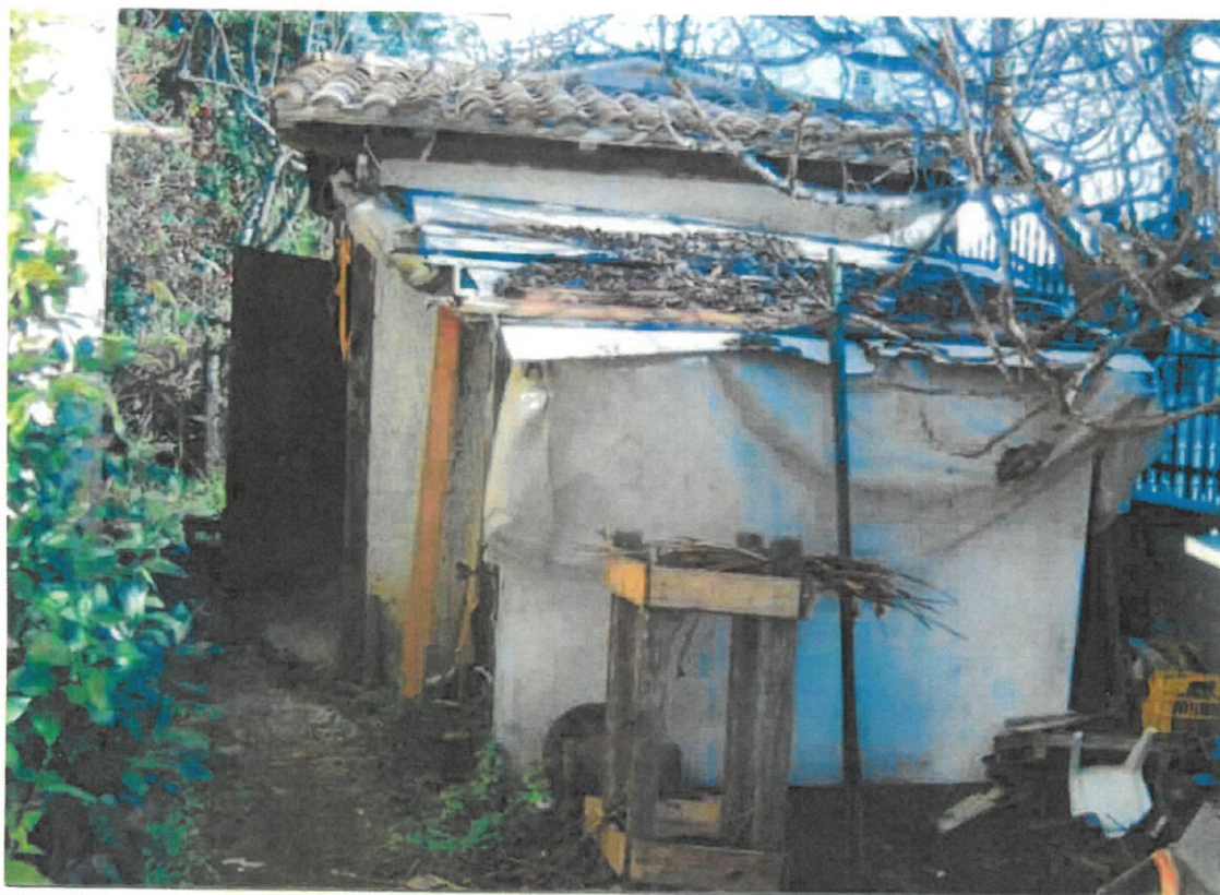
Foto n. 36 – Manufatto in muratura da ridurre in pristino, ubicato sulla corte comune in prossimità dell'abitazione (piano terra – LOTTO N. 3) sita in Lariano (Rm) – Piazzale Martiri della Libertà n. 3
