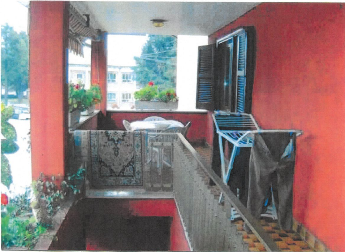
Foto n. 21 – Interno dell'abitazione (piano primo – LOTTO N. 2) sita in Lariano (Rm) – Piazzale Martiri della Libertà n. 5 – balcone in parte da ridurre in pristino
