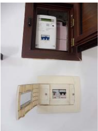
_contatore e quadro elettrico
