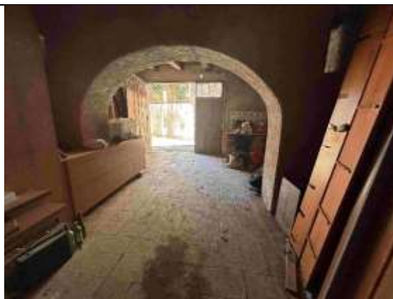
Interno locale terraneo sub 10
