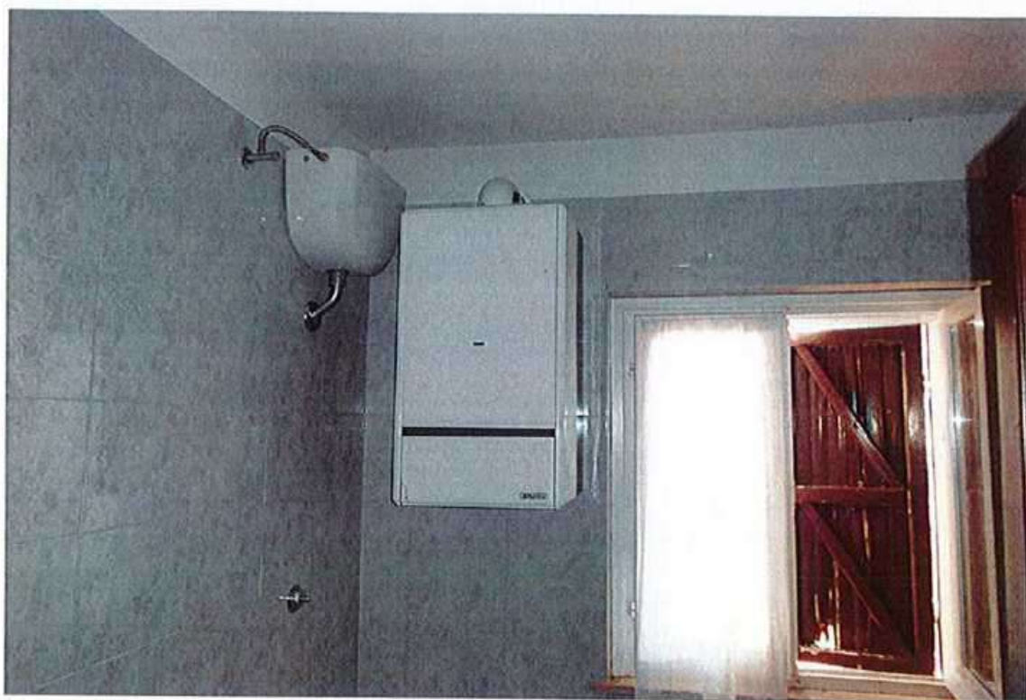
Caldaia Piano Terra su bagno
