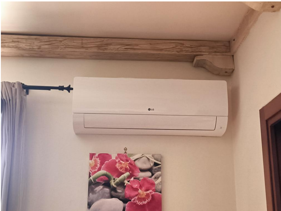
Fotogramma n. 16 Condizionatore del Soggiorno
