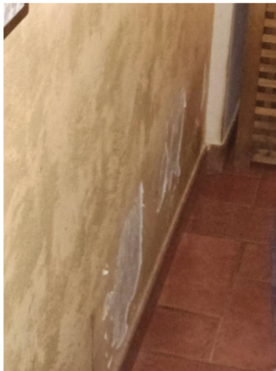
Fotogramma n. 26 Intonaco danneggiato nel Soggiorno
