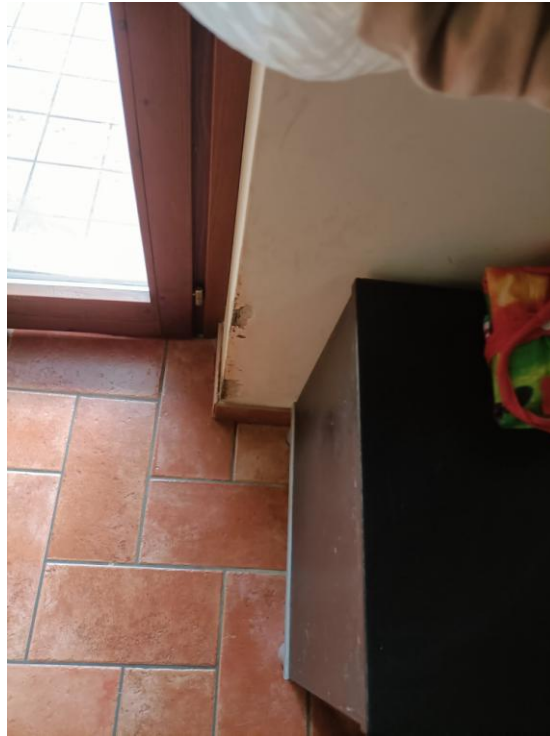
Fotogramma n. 27 Intonaco danneggiato nel Soggiorno
