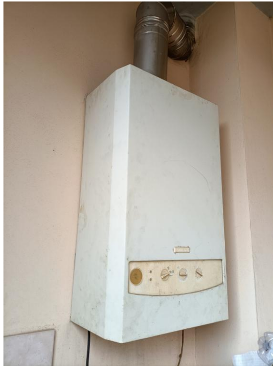
Fotogramma n. 17 Caldaia Esterna
