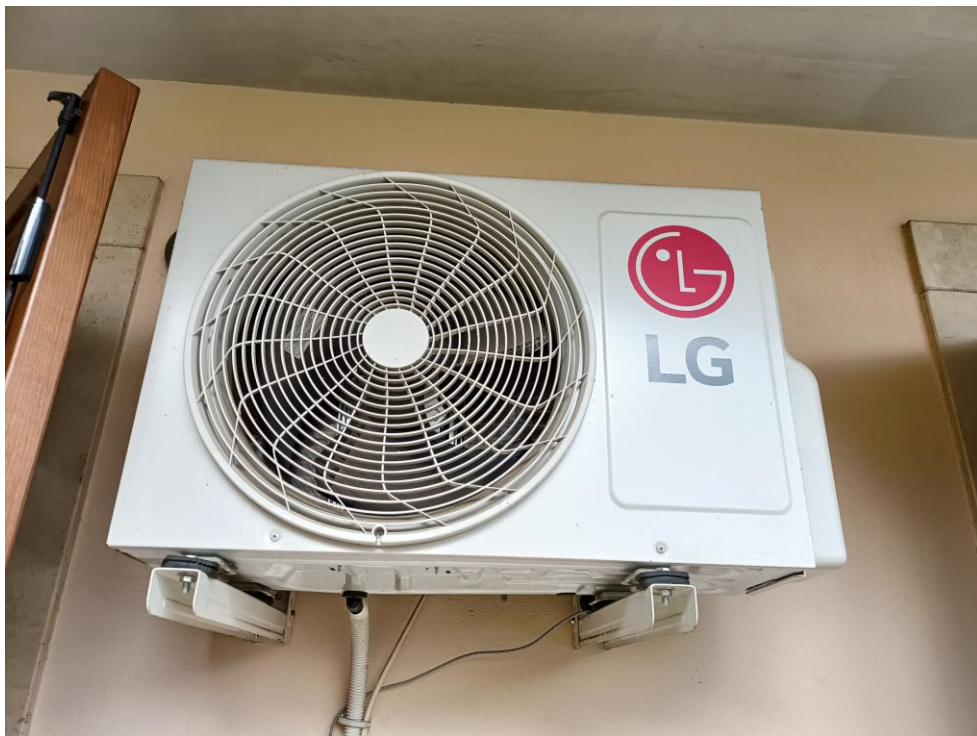
Fotogramma n. 18 Unità Esterna su Balcone Est
