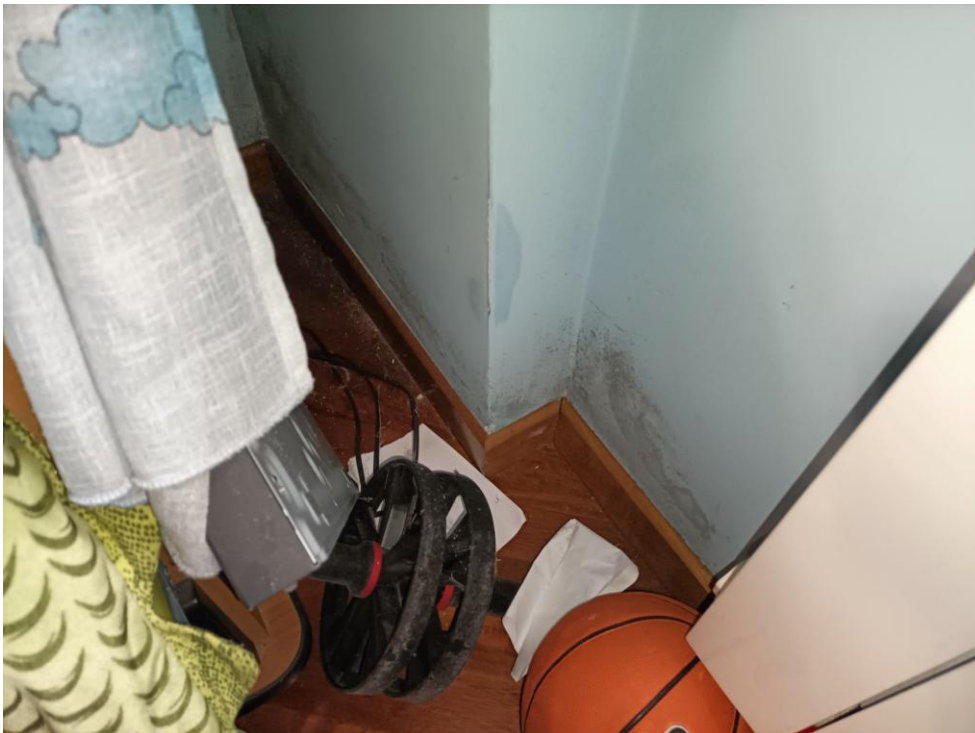
Fotogramma n. 30 Infiltrazioni Camera da Letto
