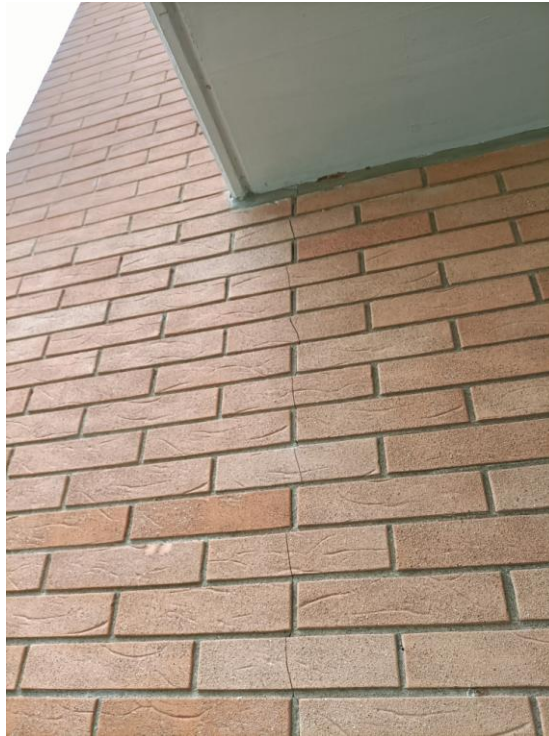
Fotogramma n. 29 Lesioni Muro Balcone Lato Nord
