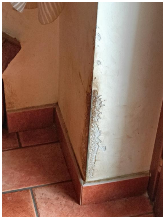
Fotogramma n. 28 Intonaco danneggiato nel Soggiorno
