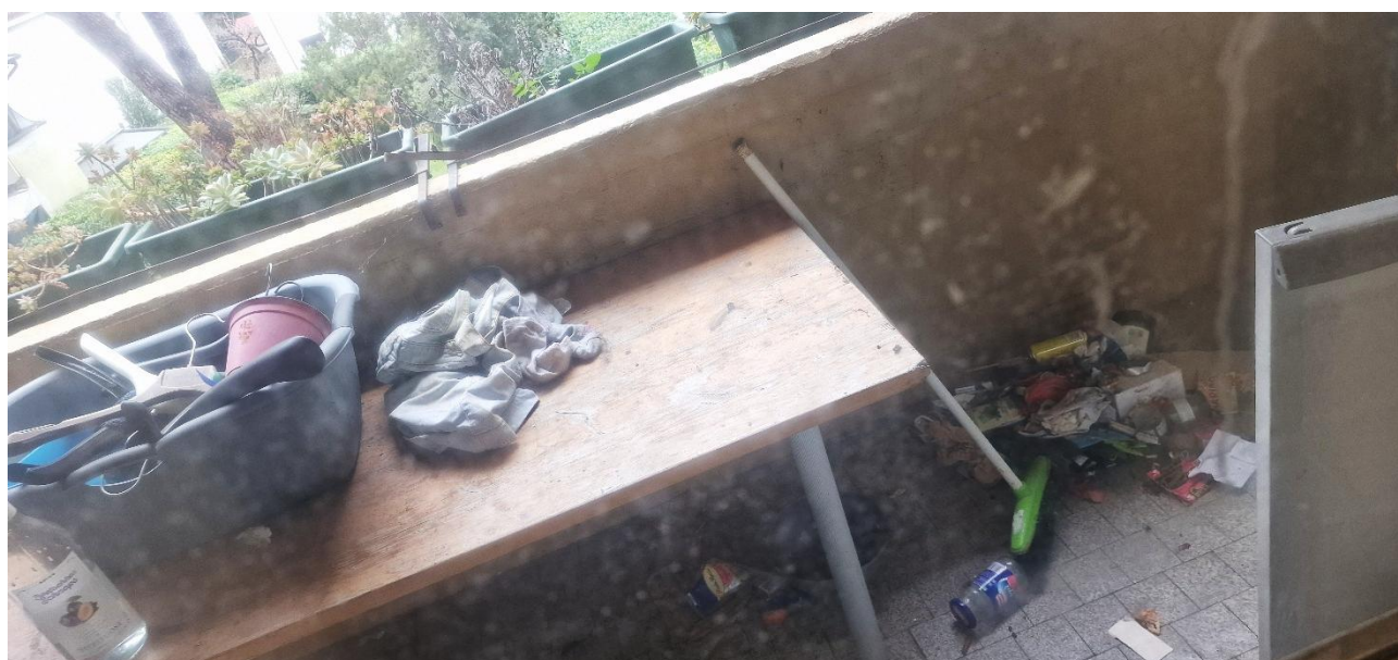
Foto n.48 – Poggiolo –vista di dettaglio n.3
