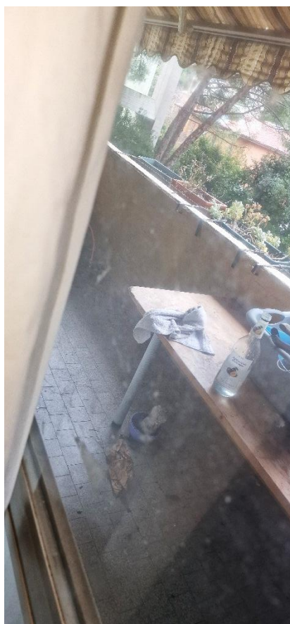
Foto n.47 – Poggiolo – vista di dettaglio n.2
