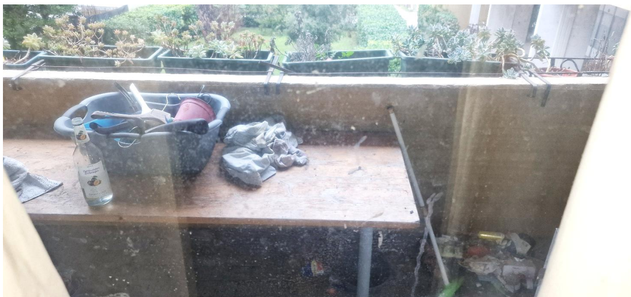
Foto n.46 – Poggiolo – vista di dettaglio n.1
