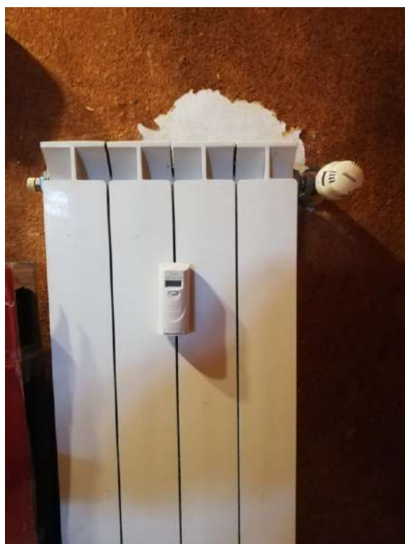
Dettaglio radiatore con conta calorie e termovalvola
