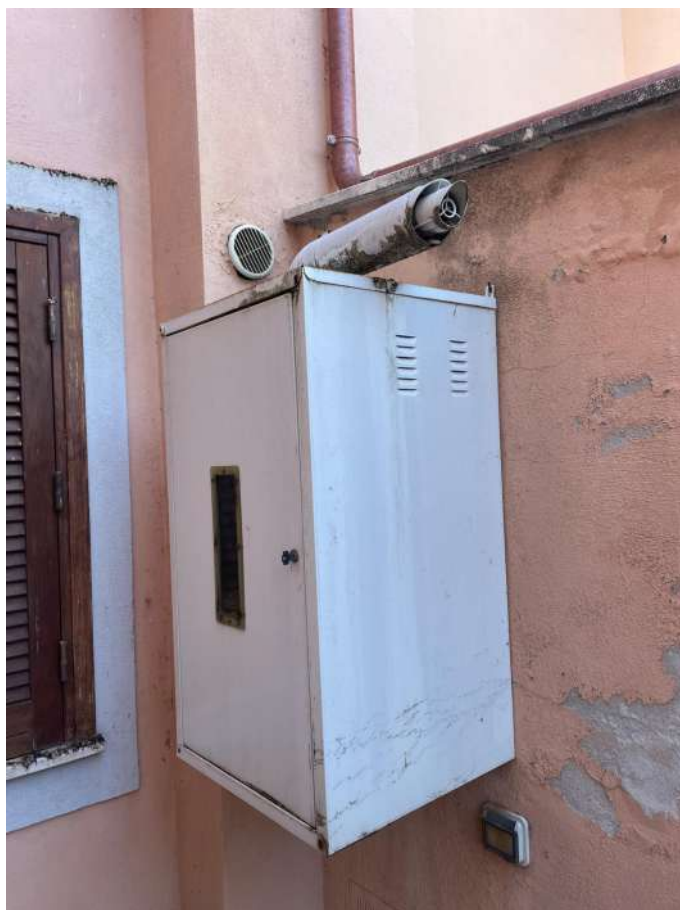
Foto 17 – Dettaglio del generatore dell'impianto di riscaldamento
