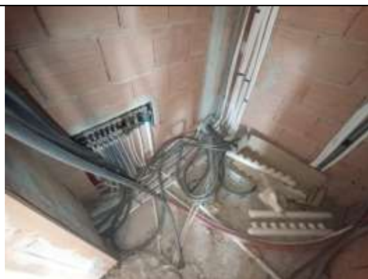
Seminterrato particolare impiantistica
