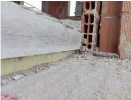
Foto 27: materiale isolante termico
