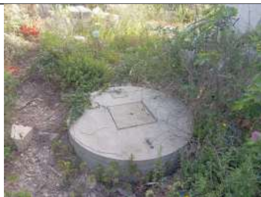
Pozzo nero a tenuta stagna lato Ovest
