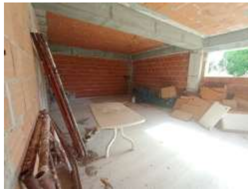
Foto 10: attrezzi di cantiere e rifiuti vari
