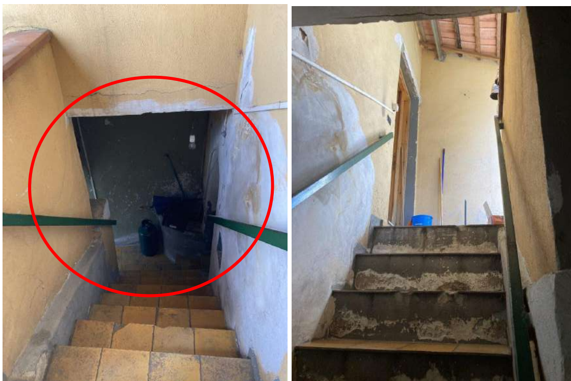
Fig. 7-8: viste del vano scala interno al Lotto Unico, privo di impianto ascensore . Si notino le variazioni cromatiche della tinteggiatura perimetrale e la presenza di intonaco ammalorato, dovute alla presenza di umidità.
