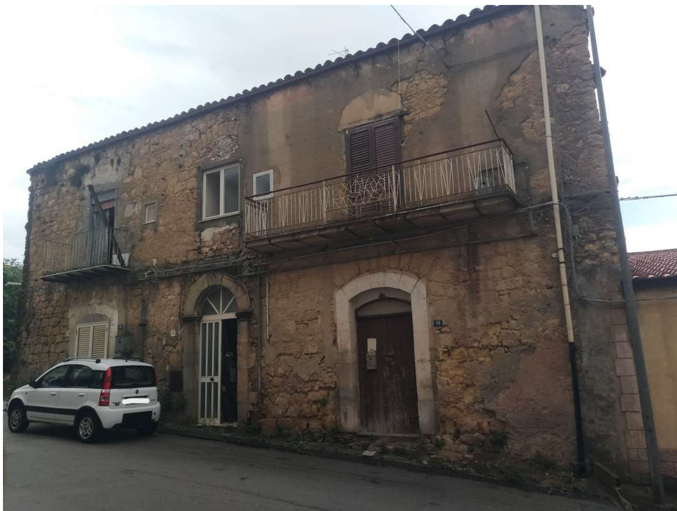
FOTO 1 --- PROSPETTO SU VIA G. GARIBALDI
