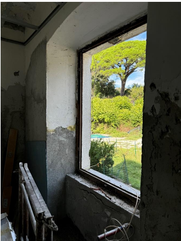
Lotto 2 – mancanza serramento – foto n. 33
