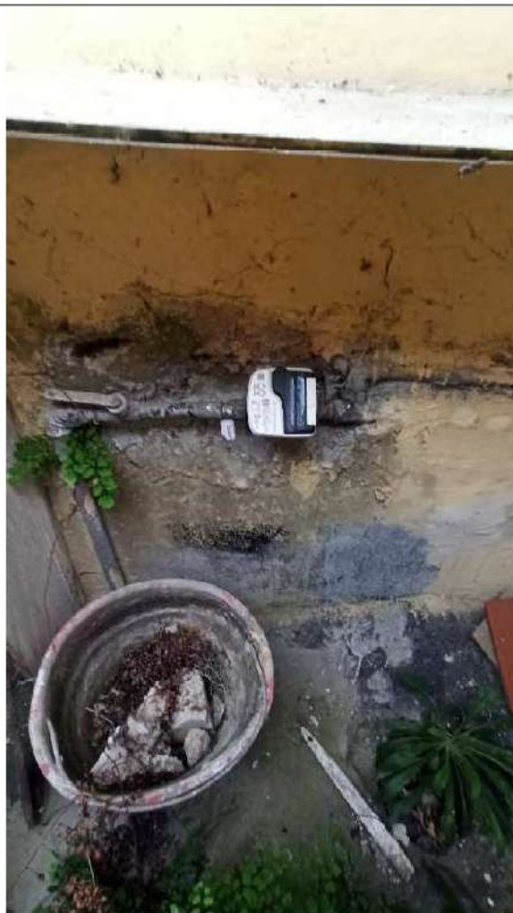
FOTO 15 – DETTAGLIO CONTATORE ACQUA
