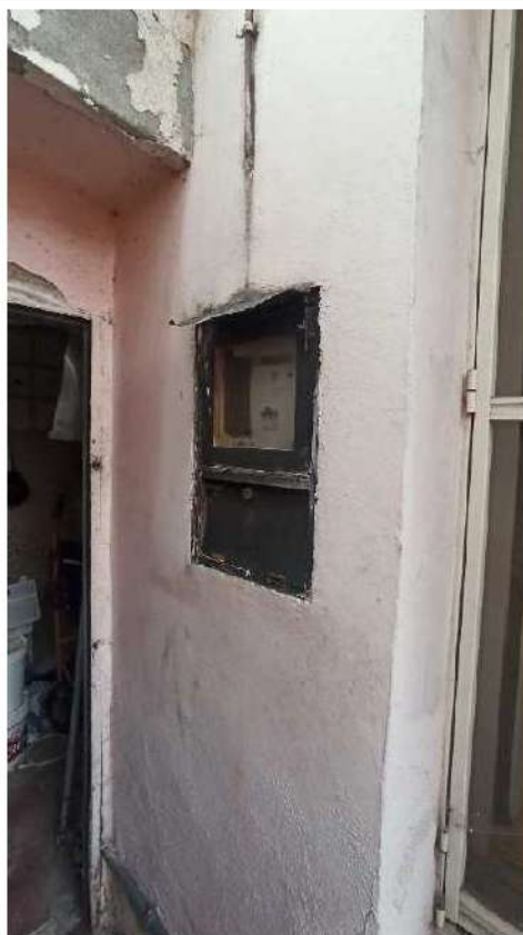
FOTO 14 – DETTAGLIO CONTATORE ELETTRICO
