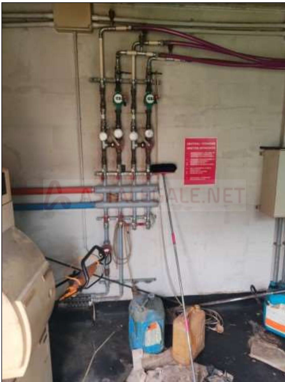
Foto n. 55 – Locale centrale termica
