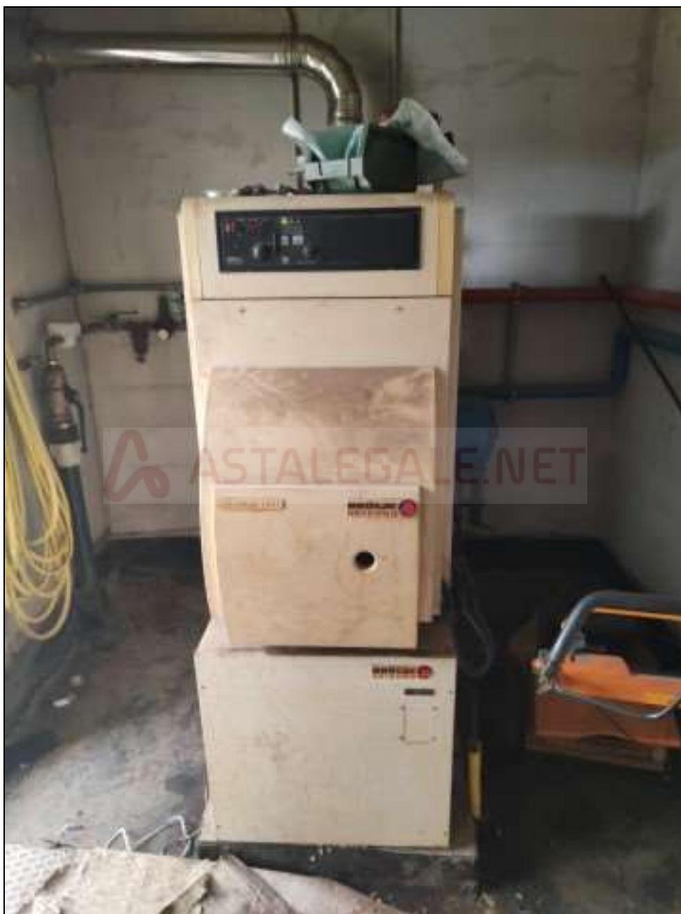
Foto n. 53 – Locale centrale termica
