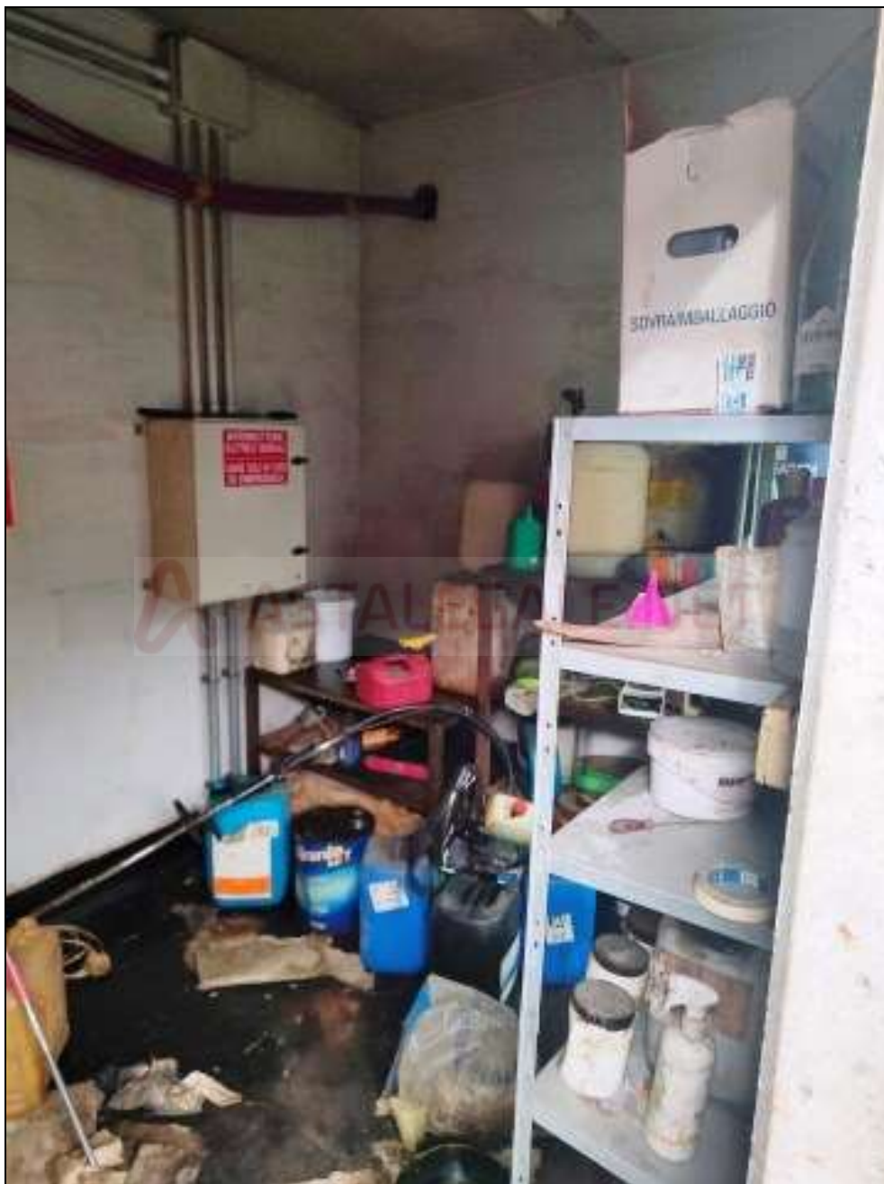
Foto n. 56 – Locale centrale termica
