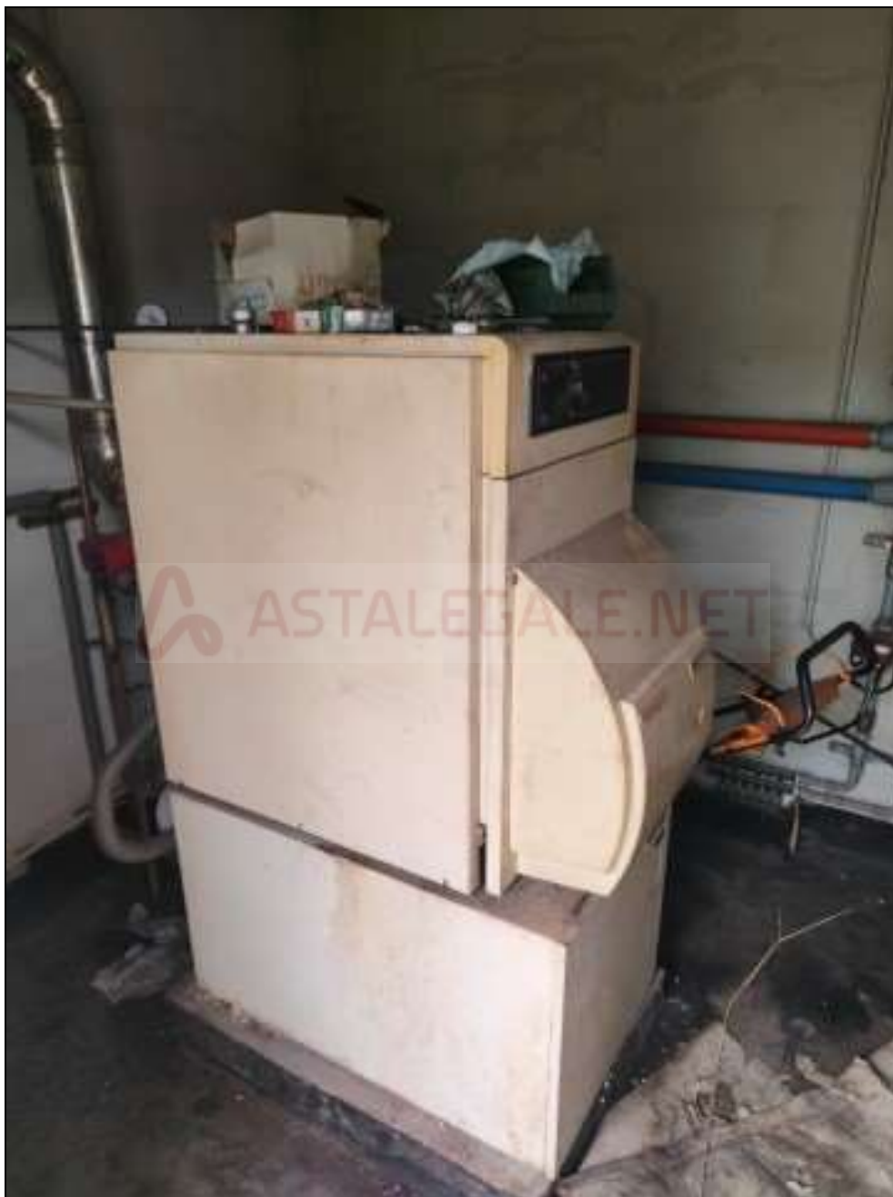
Foto n. 54 – Locale centrale termica
