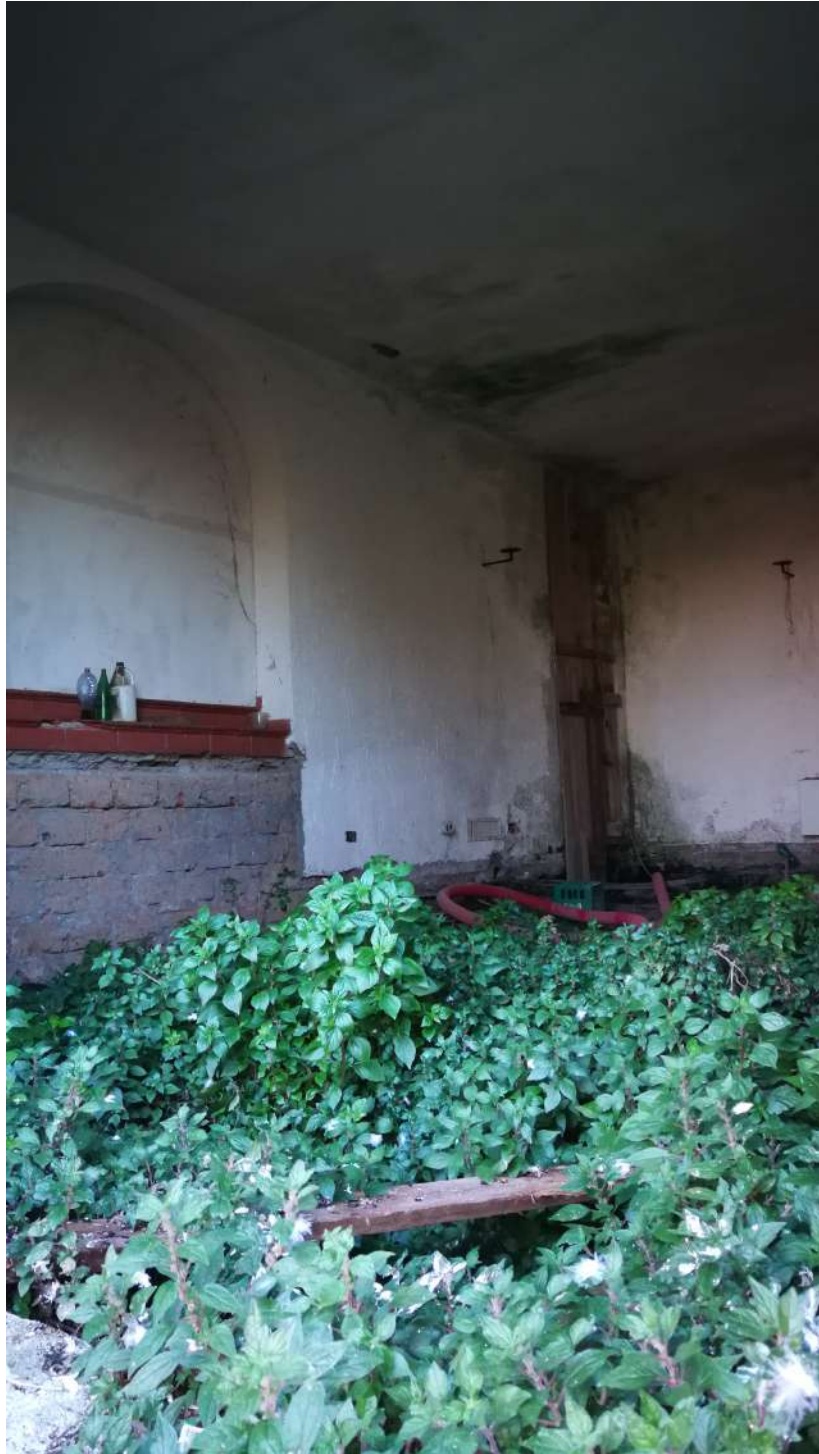
LATO GIARDINO – INTERNO SALA RISTORANTE INAGIBILE
