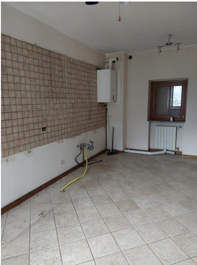
Vista dell'angolo cottura con la caldaia murale
