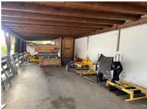
Tettoia esterna a sud (non autorizzata)
