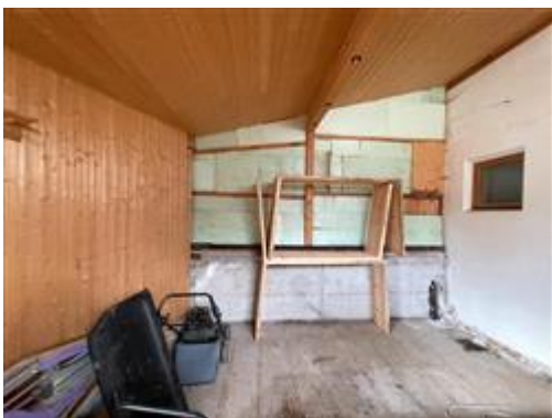
Spazio coperto ad ovest (non autorizzato)
