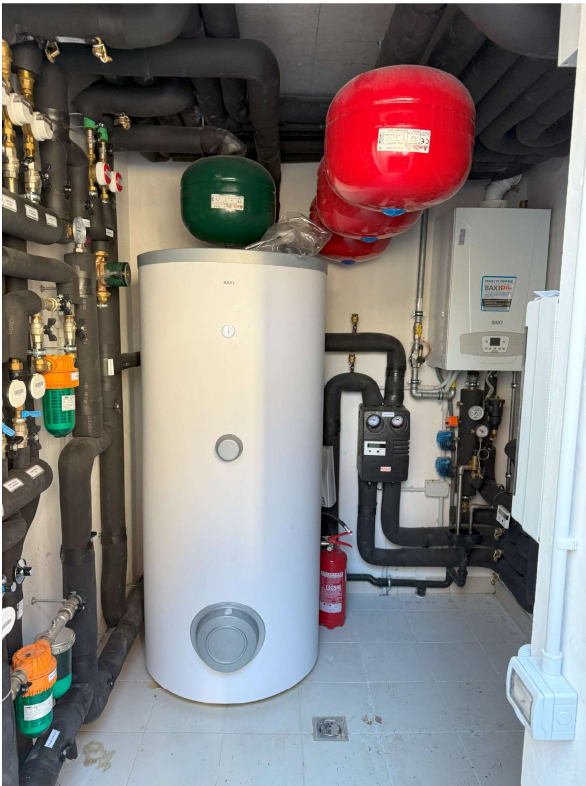
Foto 17: centrale termica comune (particella .844 sub 18 ex sub. 15)
