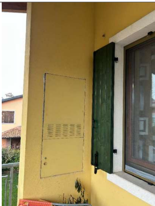
Caldaia in terrazza
