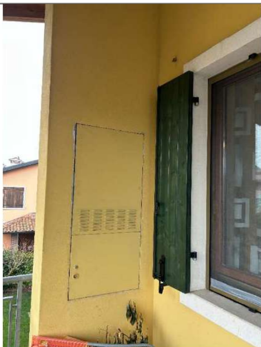
Caldaia in terrazza
