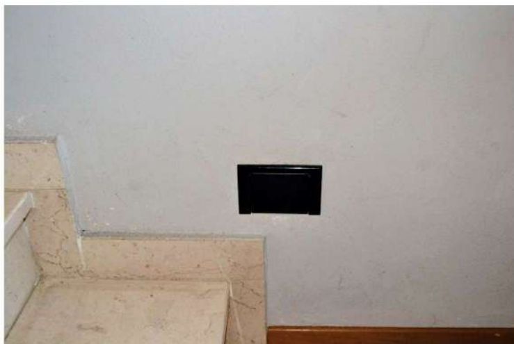
foto 4 – bocchetta di aggancio del tubo di aspirazione, con coprighiera apribile, collegata all'impianto di suzione centralizzato. Questa si trova all'imbocco della scala tra piano terra e primo piano, ma molte altre se ne trovano nell'abitazione
