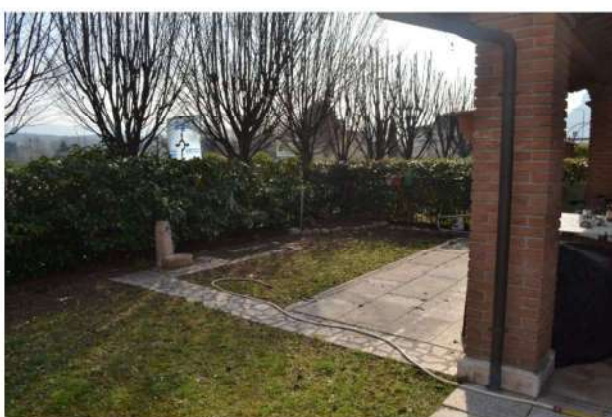
foto 5 - (sub 3) - Il giardino sul retro ha un secondo porticato e si presta al desinare all'aperto nella buona stagione. Qui come sul lato anteriore i pilastri fuori sede hanno un nucleo di cemento armato incamiciato da un rivestimento in mattoni facciavista.
