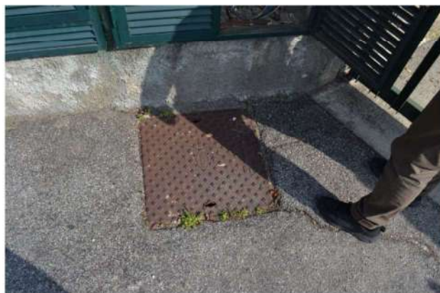
foto 10 - (sub9) - Sempre di fianco al cancello car-raio, a terra, si vede il pozzetto contatori dell'acqua. Apribile solo con l'ausilio di utensili appositi.
