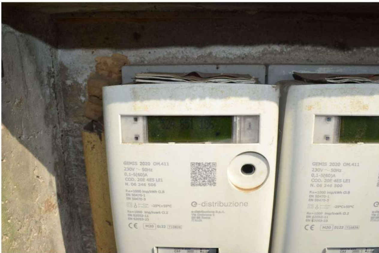
foto 7 - (sub 9) – Armadio contatori energia elettrica. Il codice utenza mostrato a display, per quanto di pertinenza alle unità pignorate, è 324 851 186. Le nicchie di alloggiamento dei contatori – anche di quelli in foto n. 9 – sono tutte ricavate su una propaggine stradale della proprietà, sul bcnc sub 9.
