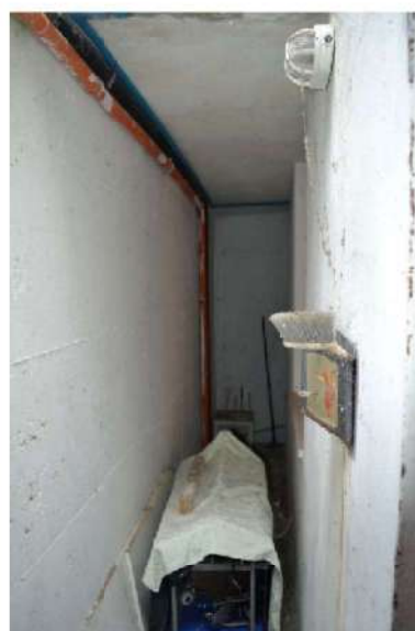
foto 9 - sub 3 (cavedio) – Tinte bianche dirette sui muri in c.a., no intonaci. Cubicoli tecnici, non abitabili; h_{int} = 2,40m (apx).
