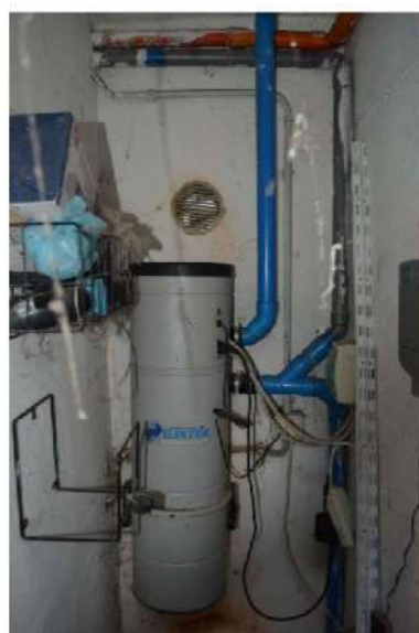
foto 8 - sub 3 (cavedio) – Aspiratore e bidone di accumulo asserviti all'impianto aspirapolveri centralizzato.
