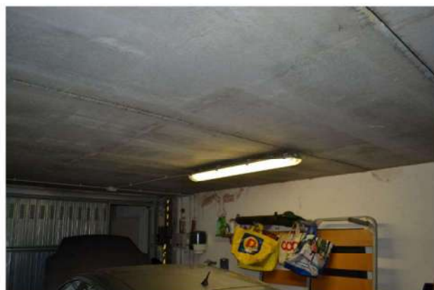
foto 19 - sub 6 (garage) – Gli orizzontamenti tra sottotrada e piano terra sono in lastre predalle , debolmente screpolate e infiltrate all'intradosso.
