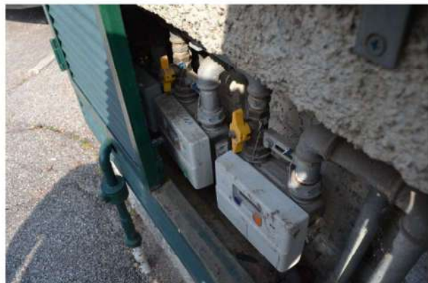
foto 9 - (sub 9) - Di fianco alla nicchia in foto n. 7 si trova l'armadio contatori del gas; anta sx bloccata.
