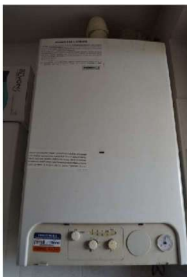
foto 21 - sub 3 (bagno 2) - Nel bagno si trova anche il generatore di calore per riscaldamento e acs, una caldaia marca Ferroli, modello Domina F 30 E. Cod. catasto -202100200416, chiave 61a602ef6. Potenza utile 30 kW, alto rendimento, responsabile dell'impianto Sabrina Perri.
