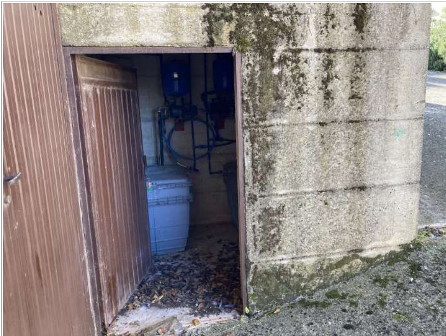
Foto 12 – Vano tecnico a comune fra i Lotti 11 e 12
