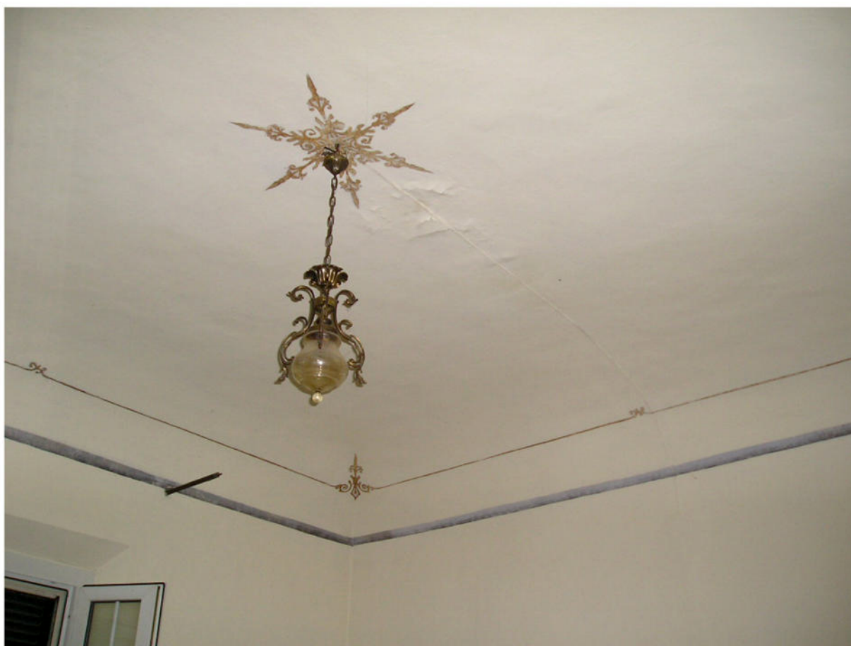
Fotografia 42 - Abitazione / Soffitto P.1
