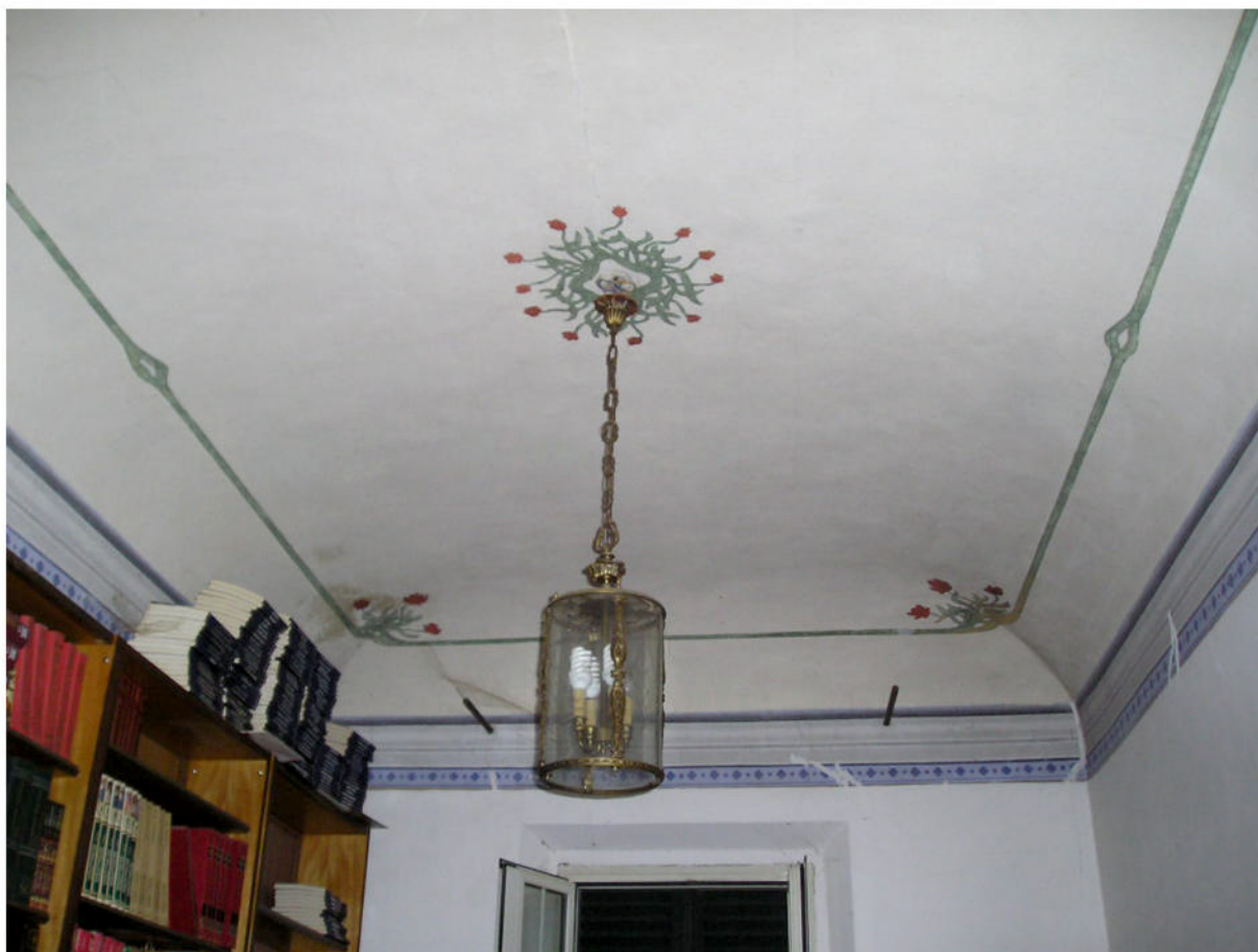
Fotografia 43 - Abitazione / Soffitto P.1
