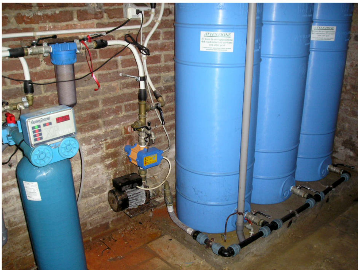
Fotografia 58 - Abitazione / Cantina P.S1 (Interrato) / Impianto Idrico
