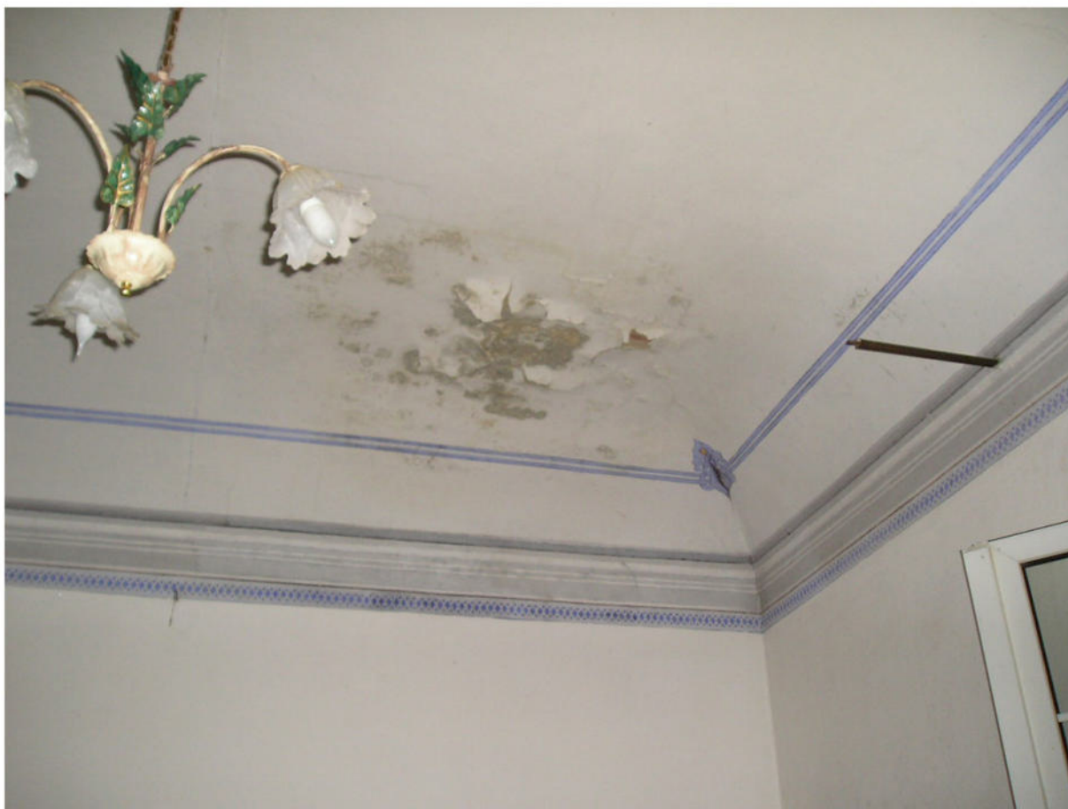
Fotografia 46 - Abitazione / Soffitto P.1
