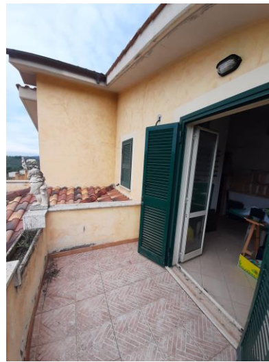
Balcone piano sottotetto non previsto in progetto, da rimuovere
