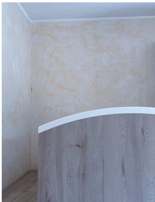
Foto 27. Lesione nella parete della camera 3.
