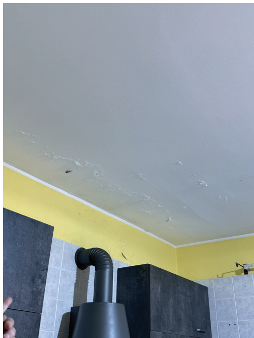
Foto 25. Distacchi d'intonaco nell'intradosso della cucina.
