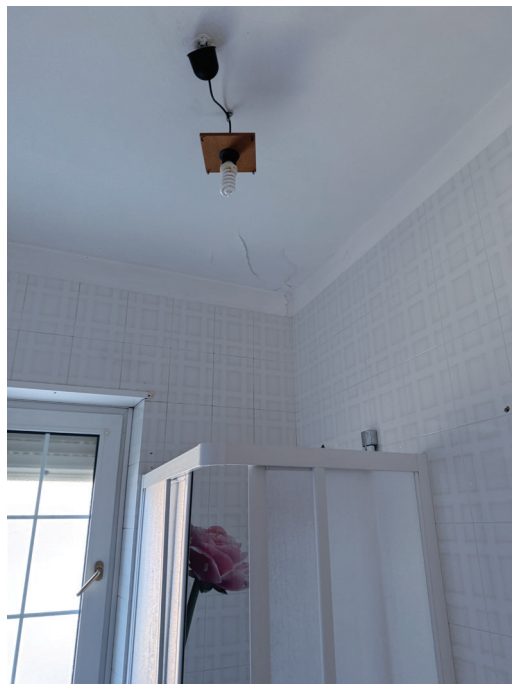
Foto 26. Distacchi d'intonaco nell'intradosso del servizio igienico.
